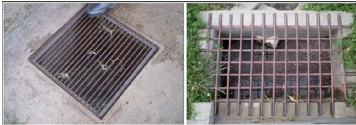
Figura 16. Cámara de retención de sólidos
