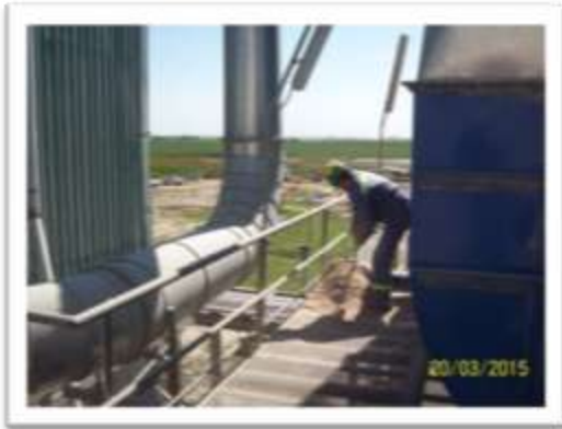
El operador localiza la falla en el sinfín de la carga de tolva (empacho del sin fin)
