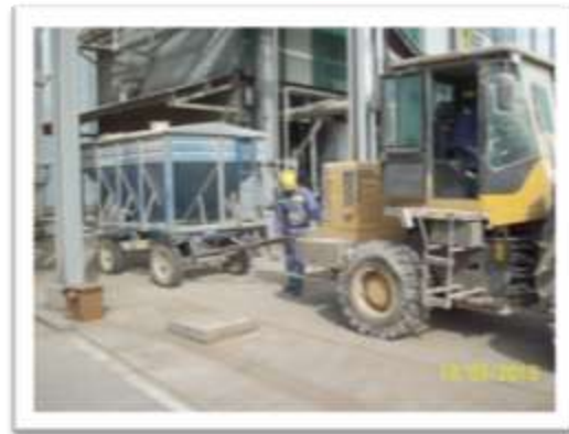
Retiro de Tolva manual
