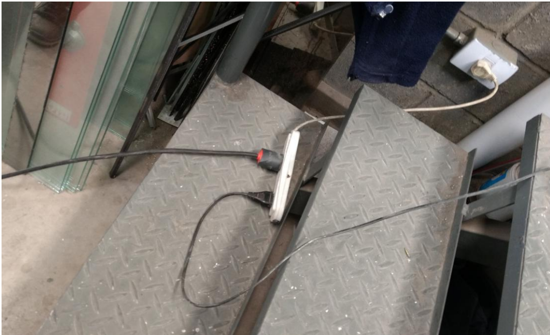
Foto N° 27 conexión de alargue a prolongador múltiple de electricidad
