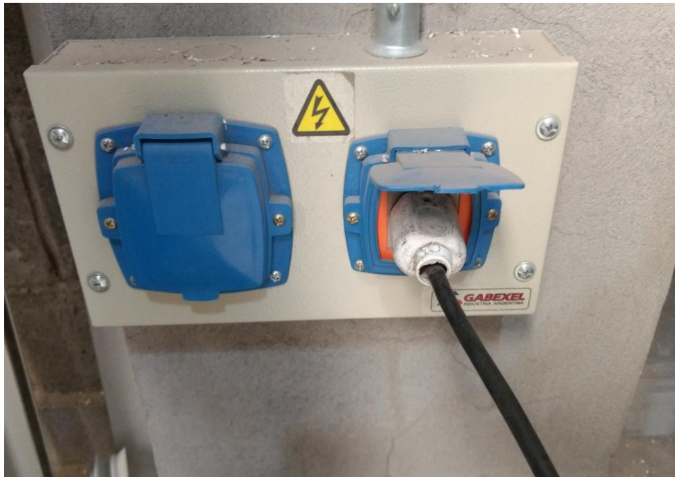
Foto N° 29 conexión toma corriente
