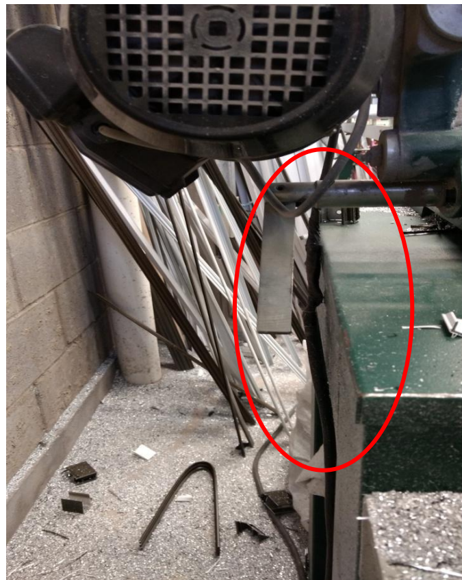
Foto N° 28 cable de maquina sensitiva con cinta aislante
