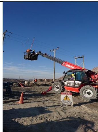
Foto N°75 certificación de ausencia de tensión.
