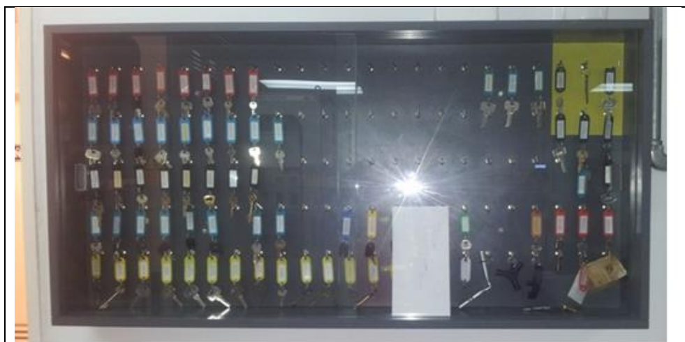
Foto N° 26 Tablero donde se ubican llaves de tableros consignadas. El mismo cuenta con tapas de acrílico.
