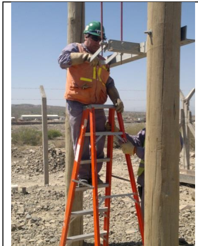
Foto N° 12 operario abriendo seccionador.
