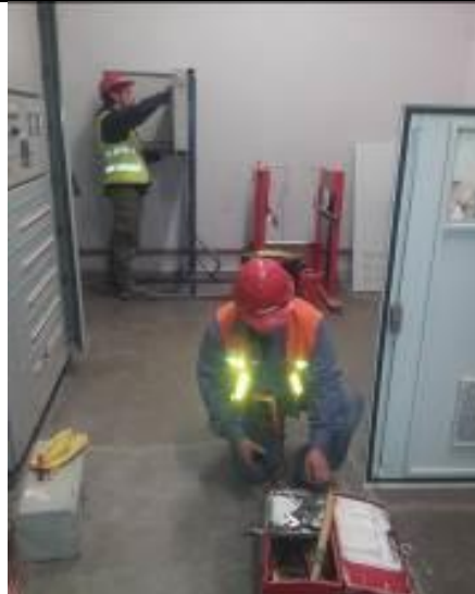
Foto N° 84 Tarea que realizaba el trabajador, intervenía un tablero sin consignación.
