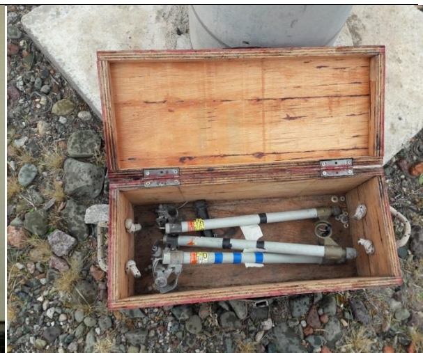
Foto N° 15 Caja de bloqueo de fusibles.
