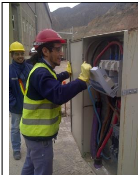
Foto N° 18 operario re energizando sin EPP di eléctricos.
