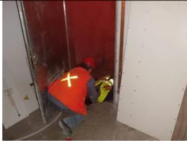
Foto N° 87 atencion primaria del accidentado y principio de incendio en tablero.
