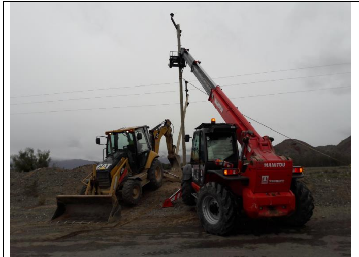
Foto N° 49 Equipos utilizados por Mantenimiento Eléctrico para realizar tarea de colocación de poste.
