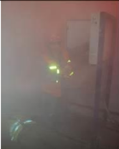
Foto N° 86 Chequeo de ausencia de tension
