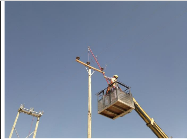
Foto N°68 cortocircuitado de Línea.
