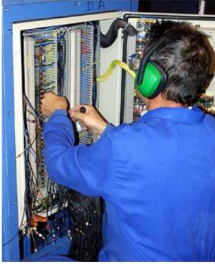
Manipulación de un cuadro eléctrico. Es en este tipo de acciones donde normalmente se producen los contactos eléctricos directos.
