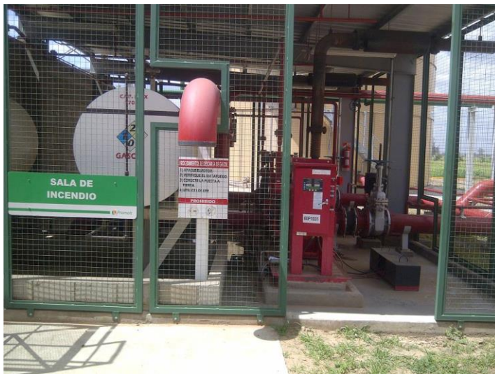
Sala de motobombas
