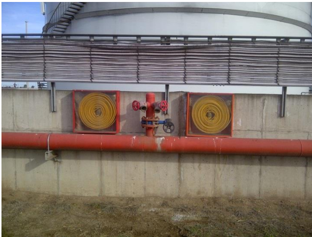
Hidrantes de playa de tanques
