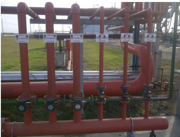
Anillo de enfriamiento de tanques
