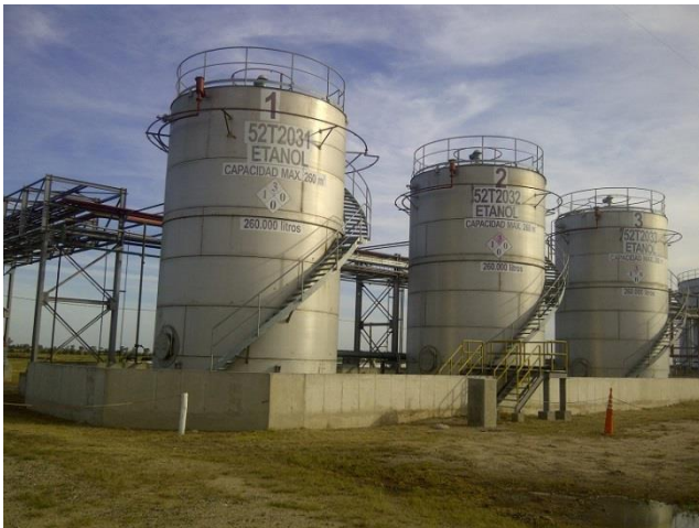
Red de incendio tanque 260 m 3
