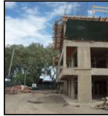
Imagen N°3.23: Falta de Prot. Contra caída de objetos
