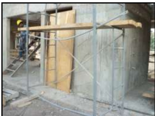
Imagen 3.20: Andamio en condición insegura
