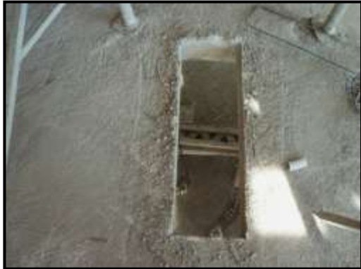
Imagen N°3.22: Aberturas de losas sin proteger
