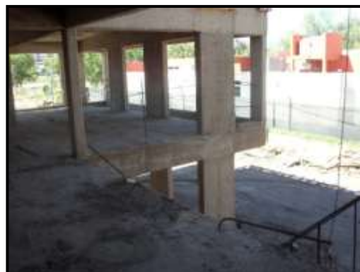
Imagen 3.21: Falta de protecciones colectivas (Barandas)
