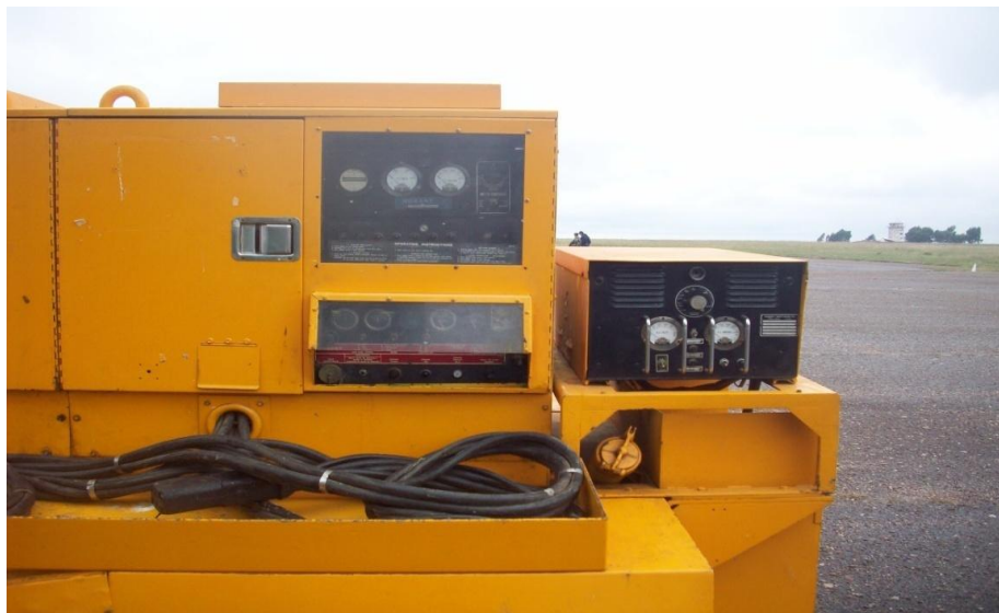
Foto N° 27 - Manguerote adujado en su receptáculo del equipo electrógeno- Fuente propia
