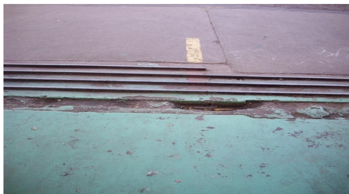
Foto N° 15- Bache en las guías de portones. Fuente Propia
