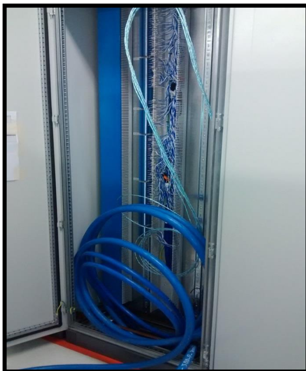
- Acometida de cables multipares en tableros
