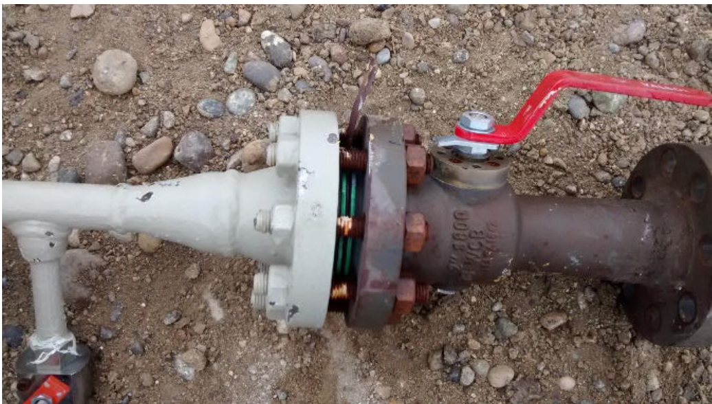
Imagen 11 - Unión bridada post válvula, consignada físicamente por medio de un chapeo.
