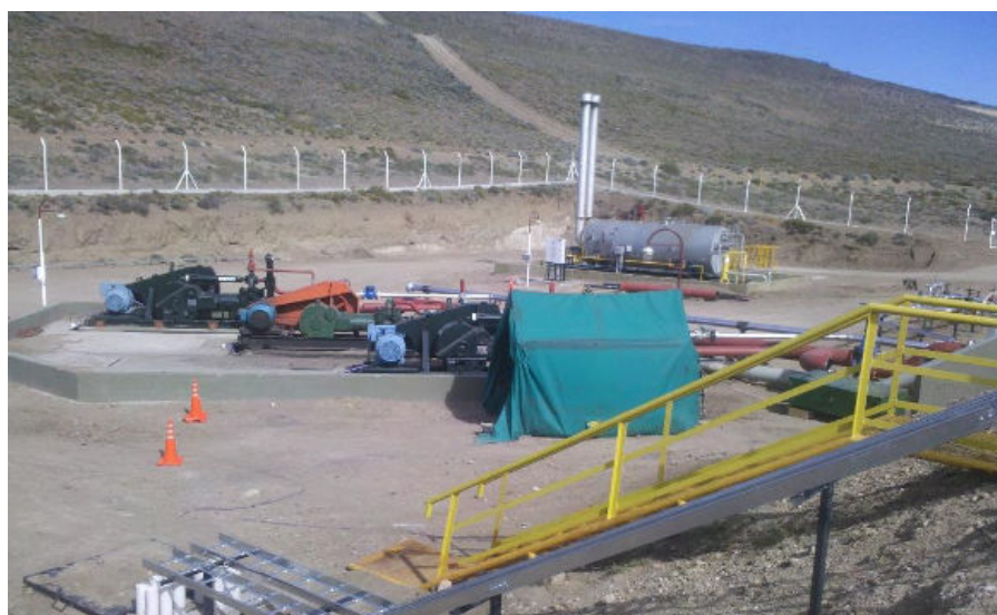
Imagen 14 – Carpa de soldadura próximo a sector de bombas de planta de tratamiento de crudo.
