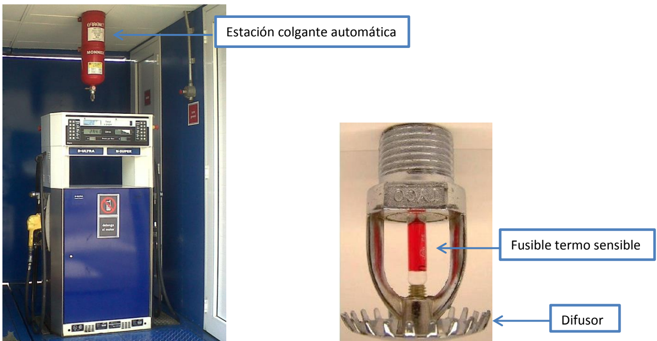
Estación automática sobre surtidor, ampliado se observa el rociador con el fusible termo sensible
