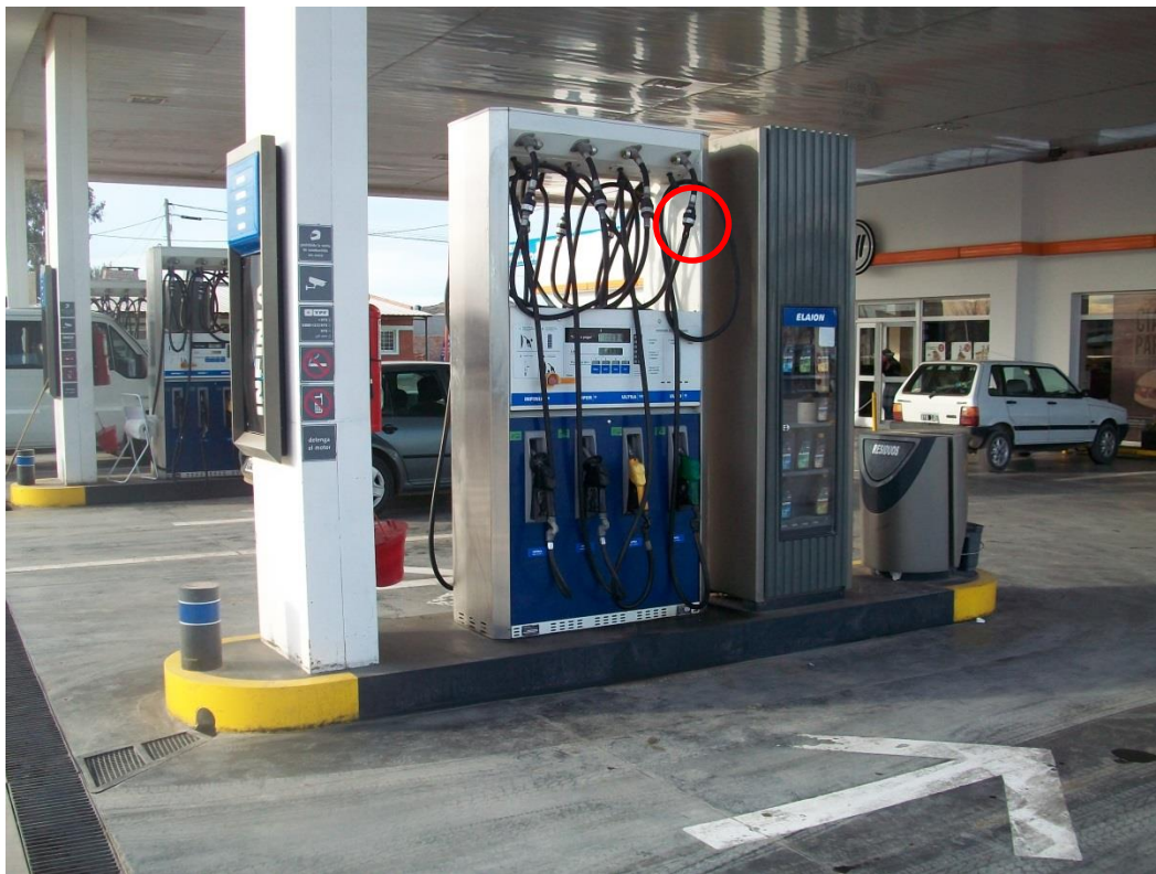
Ubicación de la válvula break away en manguera del surtidor
