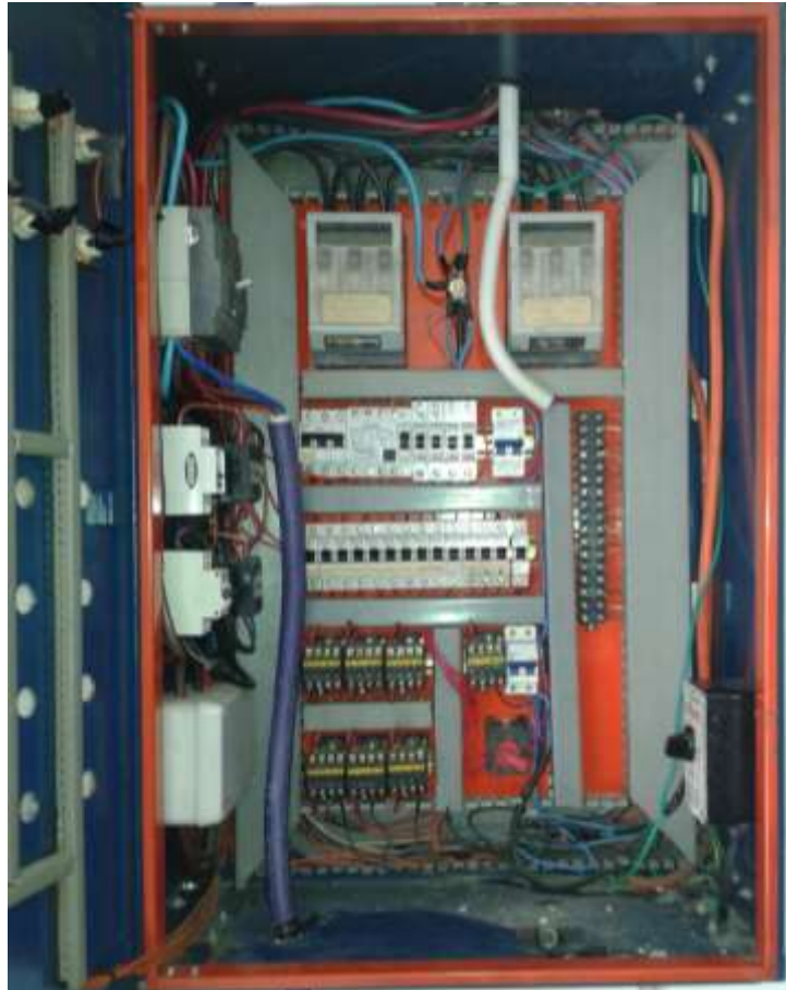
Figura 38: Tablero general de entrada.
