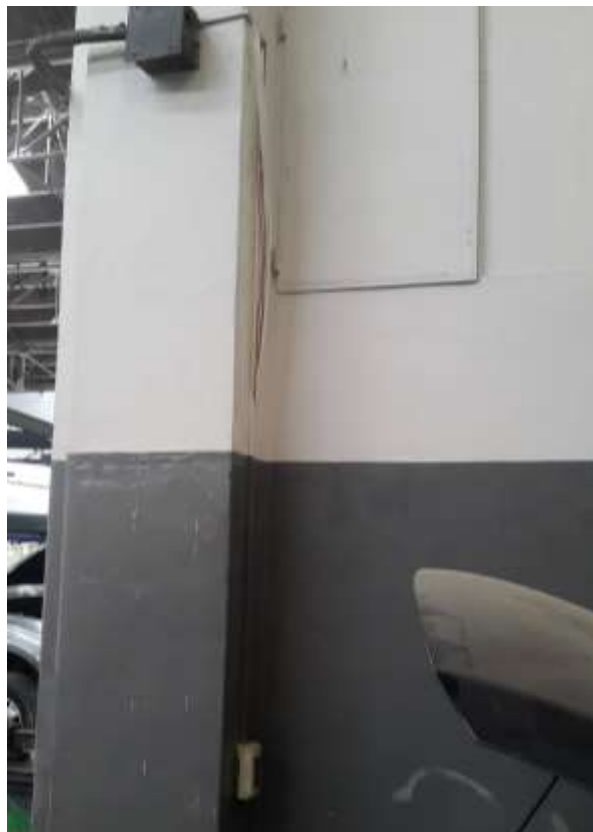
Figura 41: Cable canal en mal estado.
