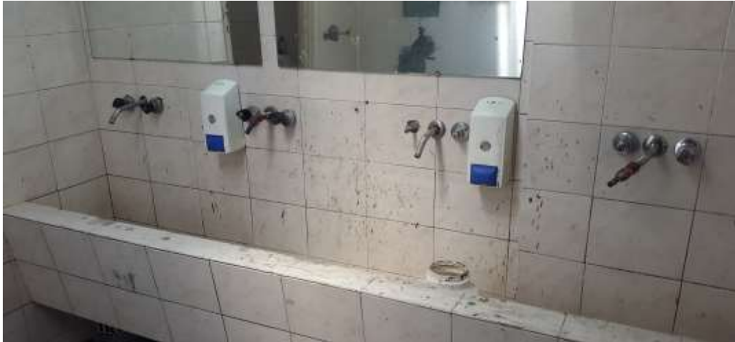
Figura 28: Piletón para aseo personal.
