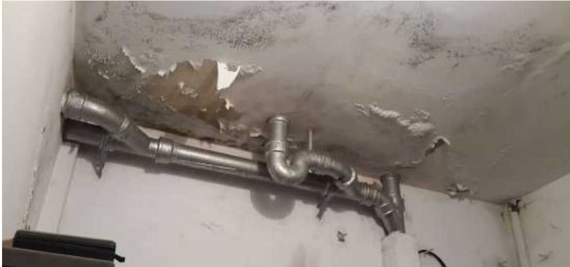
Figura 23: Deterioro en techos y cañerías.
