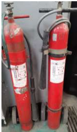
Figura 19: Extintores de carro en mal estado.
