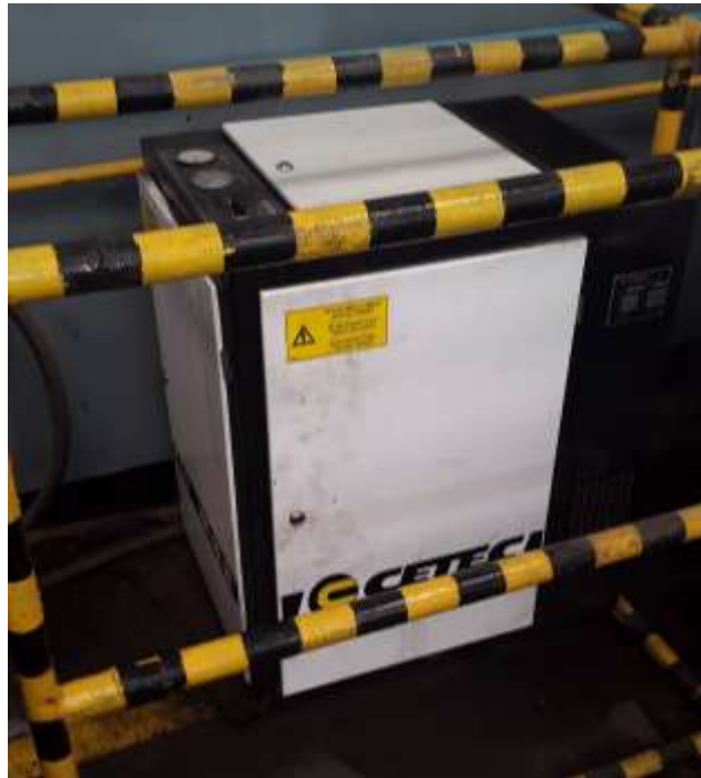
Figura 58: Compresor de aire a tornillo.
