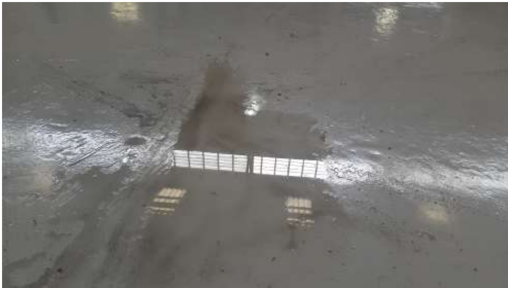
Figura 10: Acumulación de agua.
