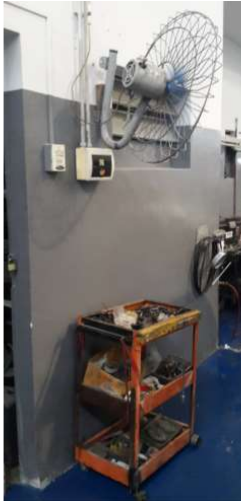
Figura 14: Ventilador mal colocado.
