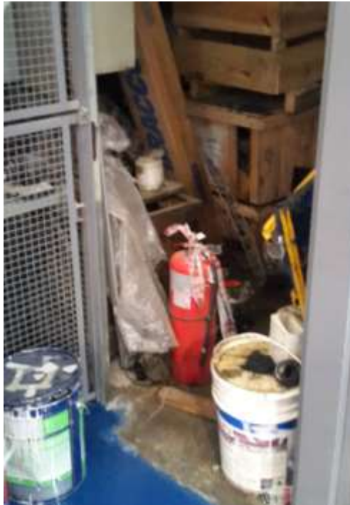
Figura 25: Ingreso obstruido a depósito auxiliar.
