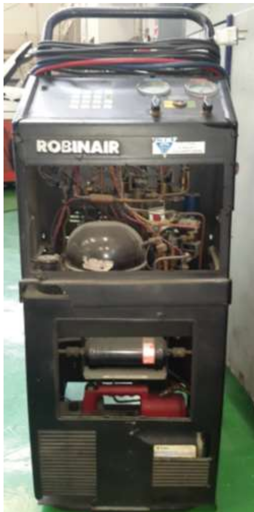
Figura 57: Estación de recarga de aire acondicionado.
