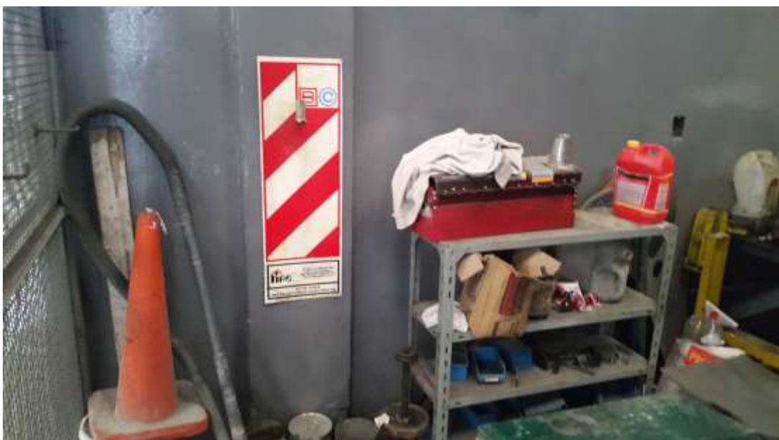
Figura 21: Chapa baliza sin extintor dentro del pañol.
