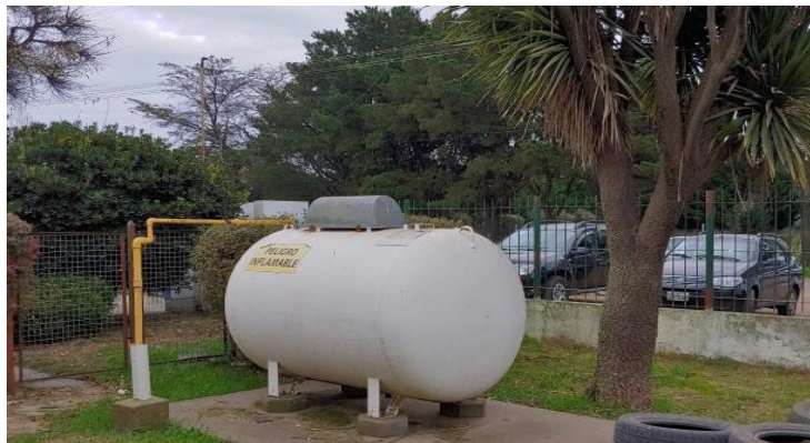
Imagen 7.11. Tanque de almacenamiento de gas propano. Fuente: Elaboración propia.
