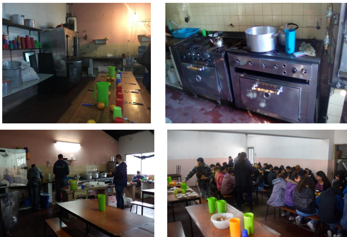
Imagen 7.7. Estado del comedor y la cocina. Fuente: Elaboración propia.
