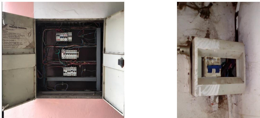
Imagen 7.9. Tableros eléctricos principal y secundario. Fuente: Elaboración propia.
