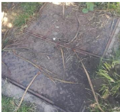
Imagen 7.17. Tapa de la cámara séptica. Fuente: Elaboración propia.
