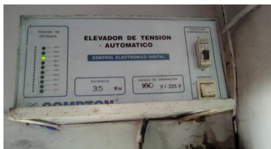
Imagen 7.10. Elevador automático de tensión. Fuente: Elaboración propia.
