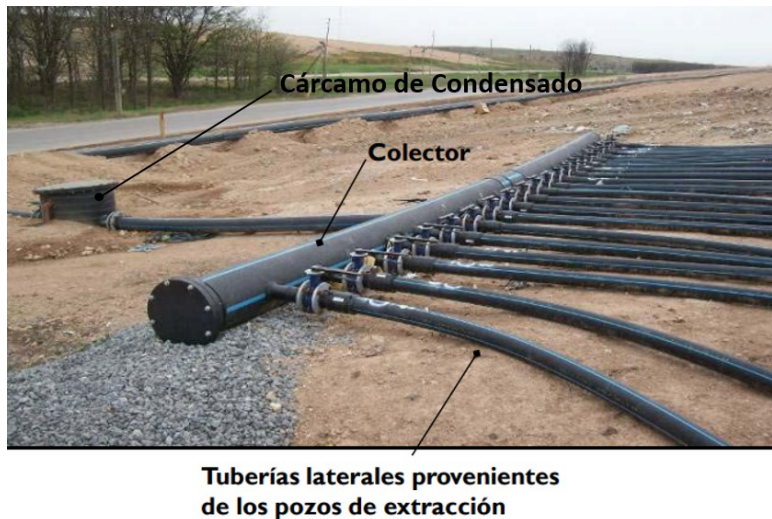
Imagen 19. Tuberías Laterales (Weihs-Biogás)
