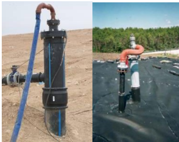
Imagen 14. Pozo de extracción vertical (Weihs-Biogas)
