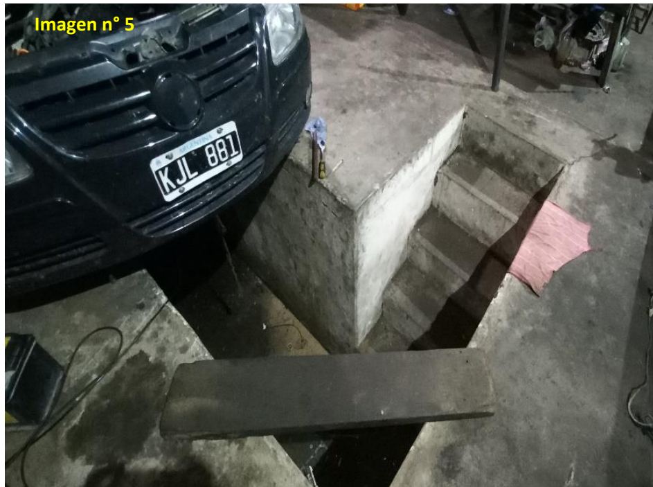
Imagen 5 fosa de trabajo sin delimitaciones y fluidos sobre el suelo
