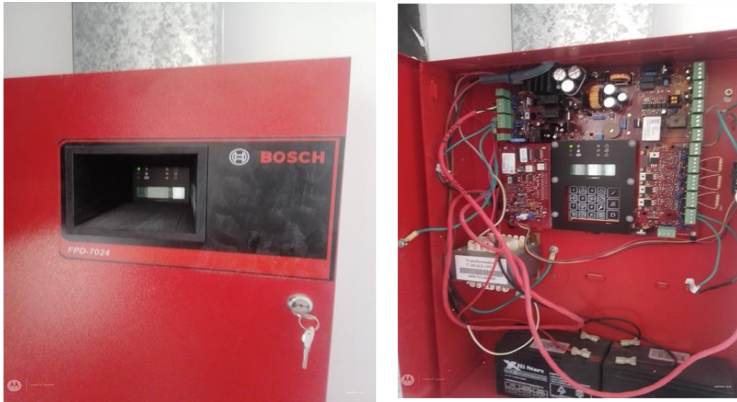
Panel control del equipo de central de alarmas
