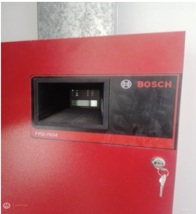
Equipo de Central de Alarmas
