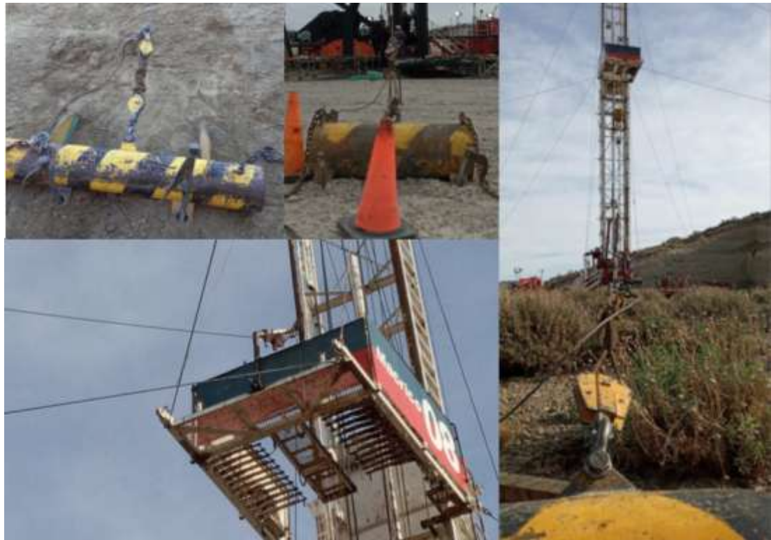
Figura 18 Sistema Descensor de Emergencia montados en distintos equipos
