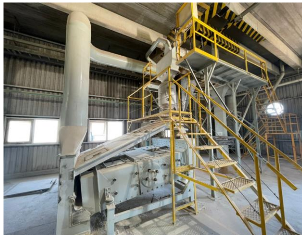
Foto 3. Cinta pesadora c/imán permanente, electroimán, zaranda y tolvas temporarias.
