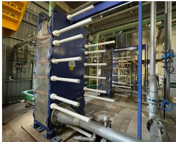
Foto 11. Intercambiadores de calor.
