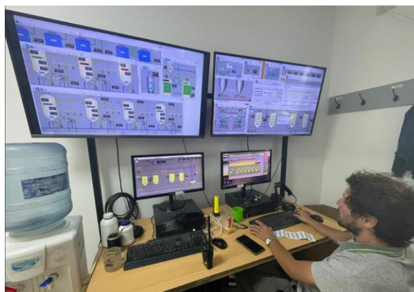
Foto 12. Sala control/operación MLF.
