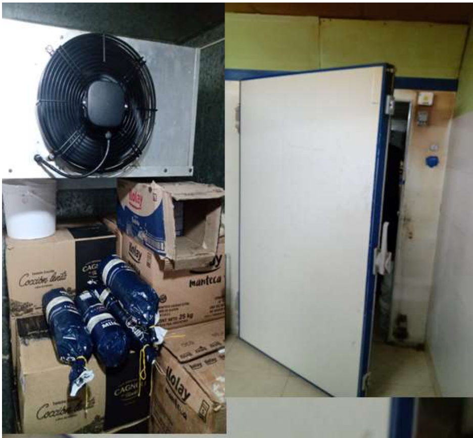
Cámara de frío vista interior / vista exterior
