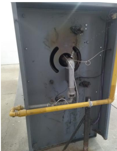
Instalaciones de gas
