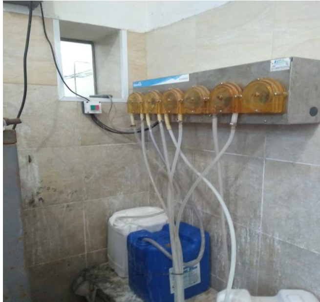
Carga de productos mediante dispositivos automáticos
