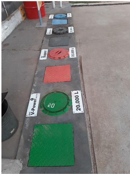
Fotografía boca de tanques
