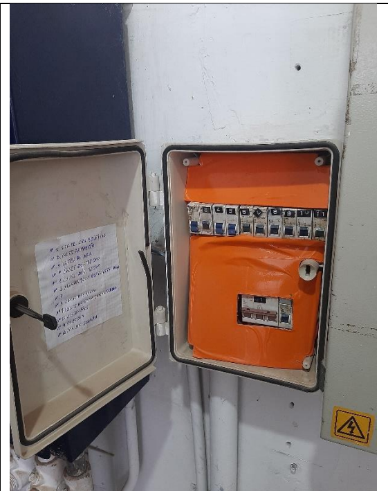
Fotografía tablero Seccional
