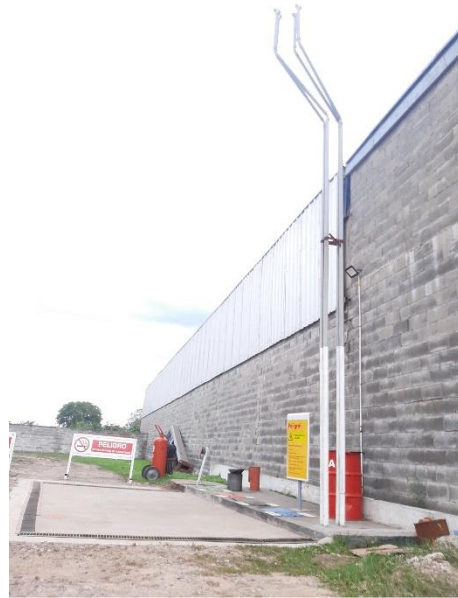
Fotografía tubos de venteo de gases
