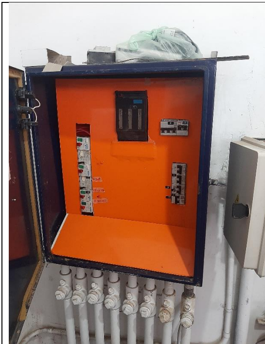
Fotografía tablero Surtidores
