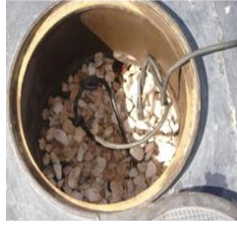
Jabalina colocada junto a las bocas de descarga
