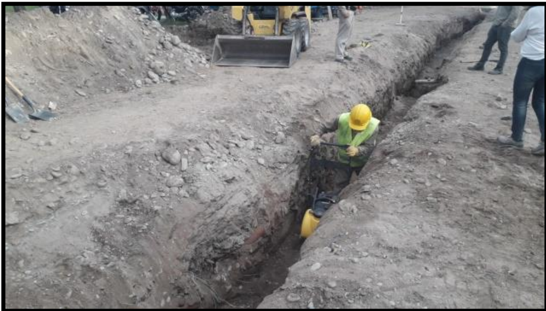
Foto 8 Tapada y compactación de zanjas luego de la instalación de cloacas nuevas.
