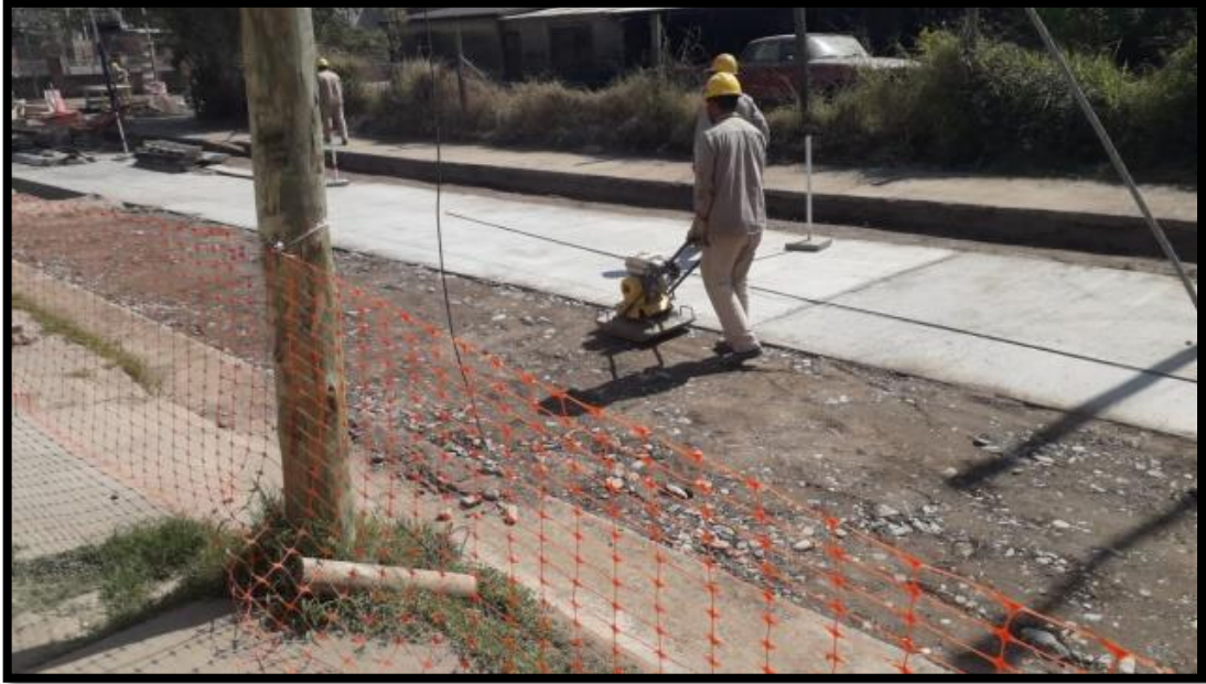
Foto 21 Preparación y compactación con plancha vibradora de caja para reposición de pavimento.
