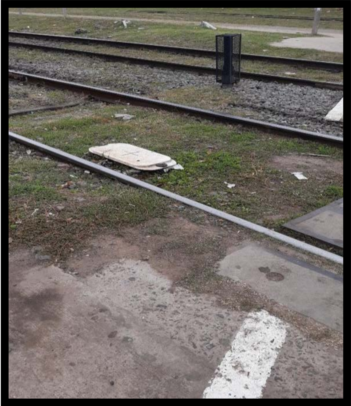
Anexo fotográfico 14 Componente eléctricos en la estación
