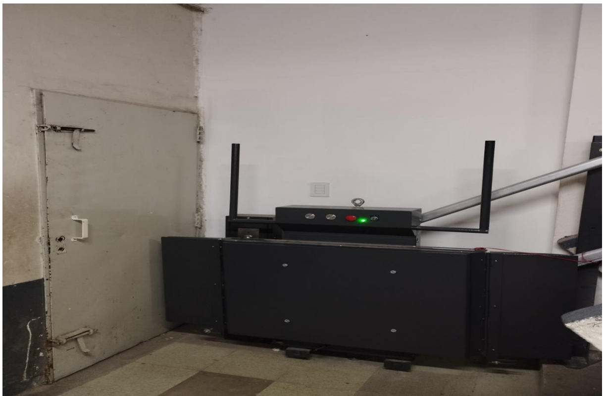
Puerta salida de emergencia salida al patio Bloqueada.
