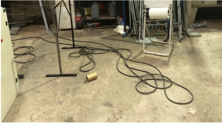
Cables en pasillo de circulación
