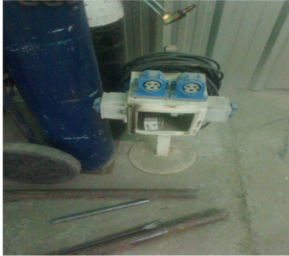
Figura 3.1 tablero terciario o móvil defectuoso
