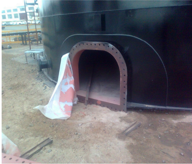
Figura 4.4 Entrada al tanque con materiales obstruyendo
