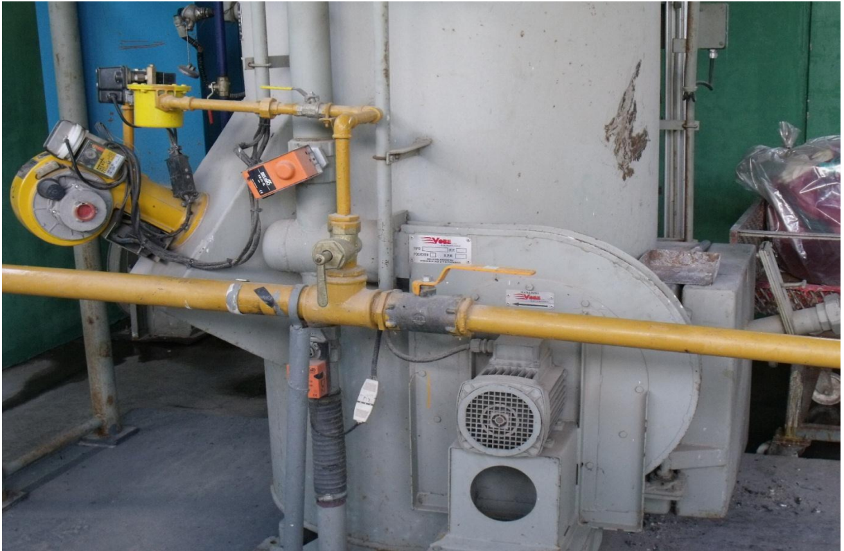
Horno Pirofítico (quemador principal y control de aire de combustión)
