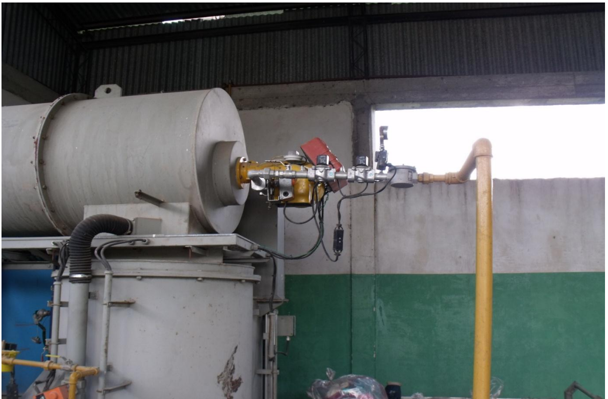
Horno Pirofítico (quemador secundario tratamiento de gases)
