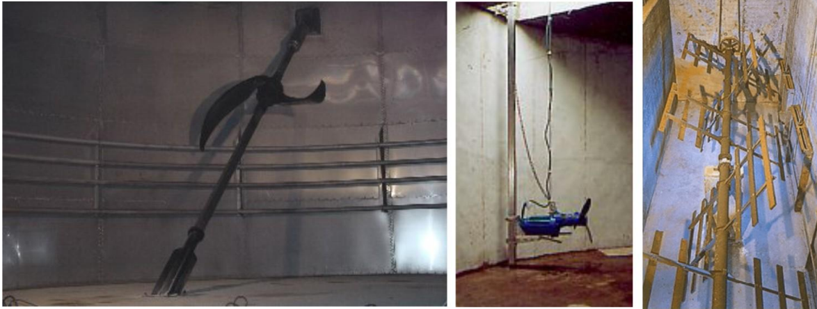
IMAGEN 4. Agitadores de tipo mecánico instalados en biodigestores. Fuente: Gabriel Moncayo Romero, "Manejo ecológicamente compatible de las cuencas del Tungurahua" Universidad Técnica de Ambato, Ecuador.
