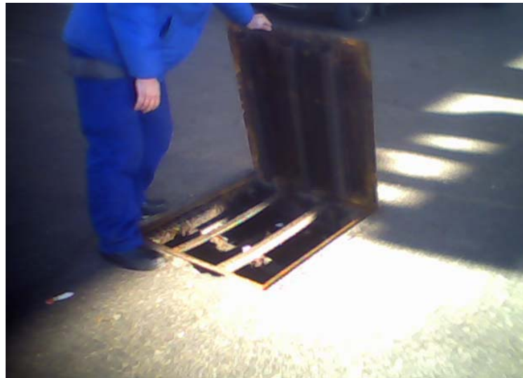
Figura 2 Cámara de separación de Efluentes.
