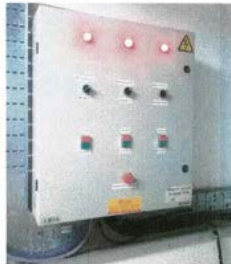
2. Tablero de incendio con llaves en automático
