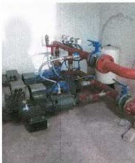
3. Bombas de incendio y caños de salida
