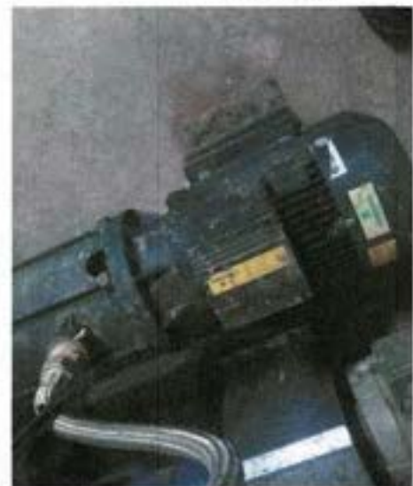
4. Bomba jockey presurizadora
