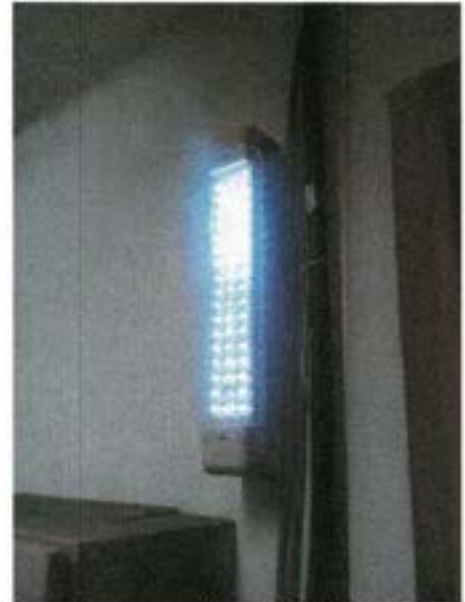
6. Luces de emergencia en Sala de Bombas
