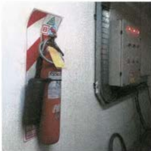
1. Extintor ABC en Sala de Bombas
