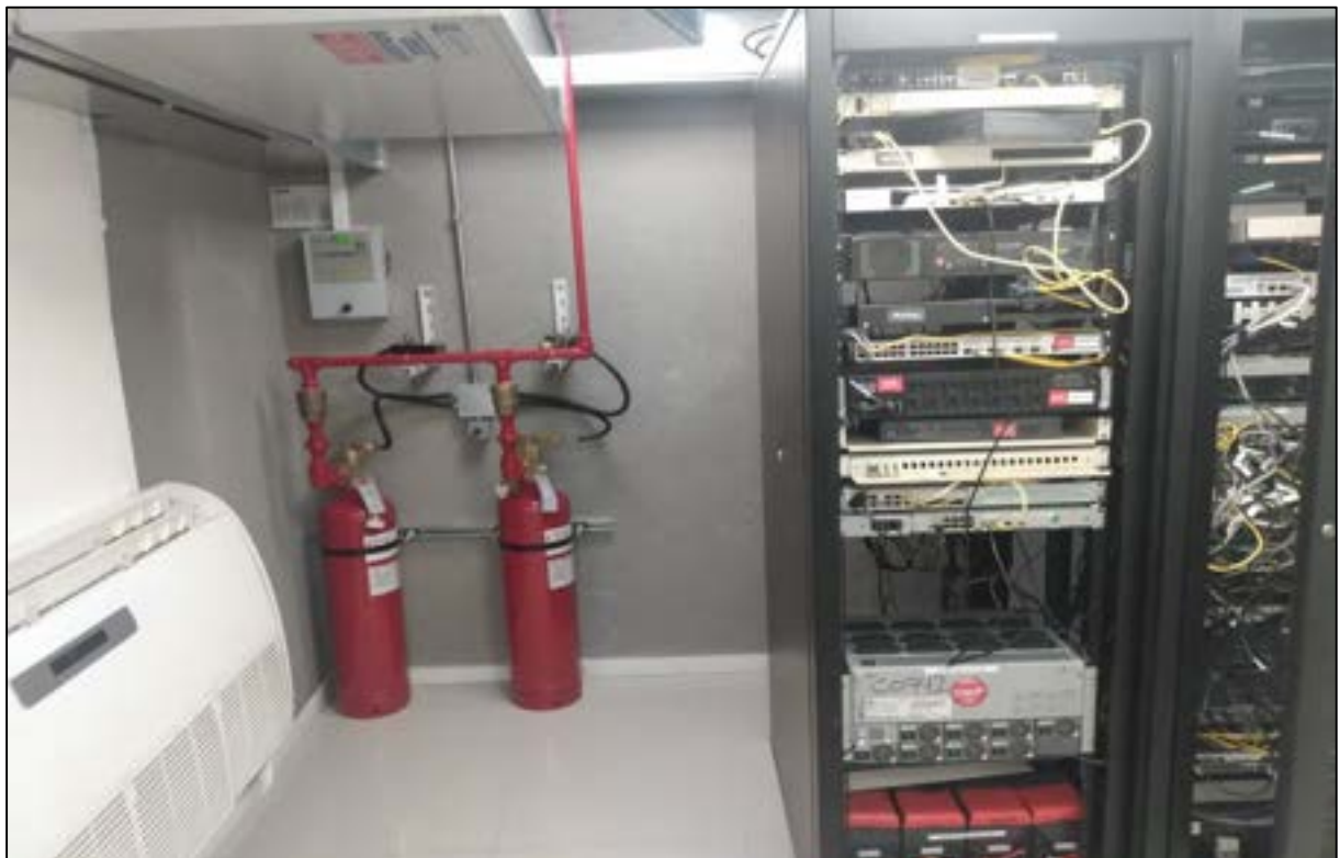
Sala de data center con sistema contraincendios NOVEC 1230 con sensores y central
