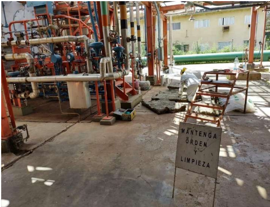
Señalización de Mantener orden y limpieza.
