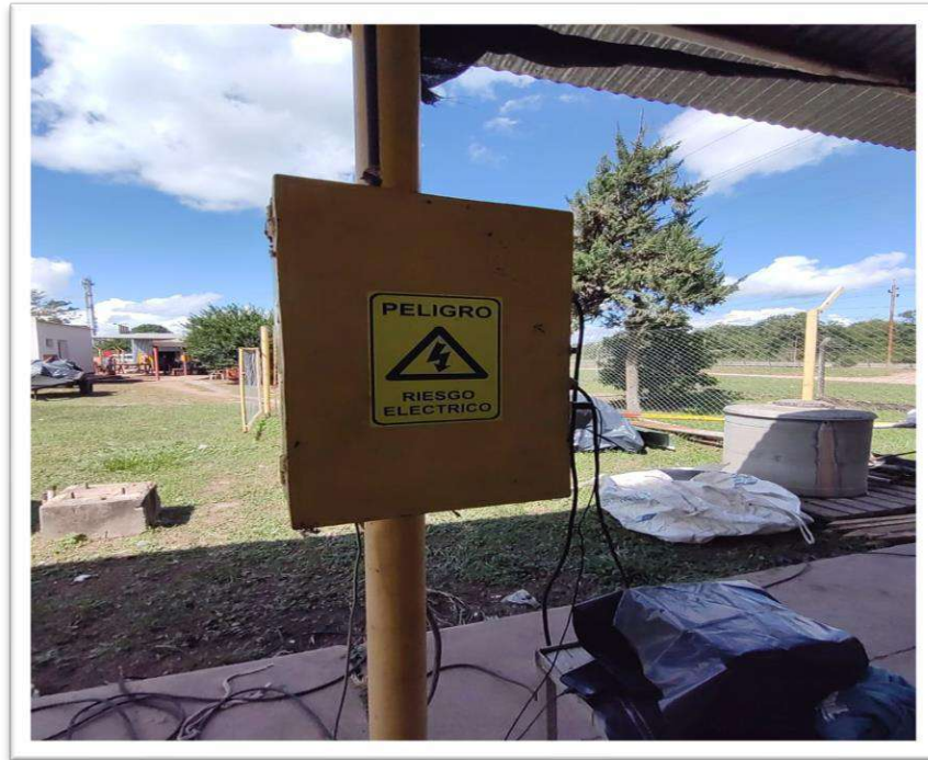
Señalización sobre riesgo eléctrico.
