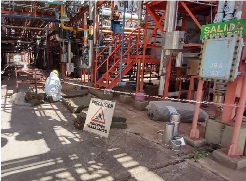
Señalización de Precaución y Evacuación.
