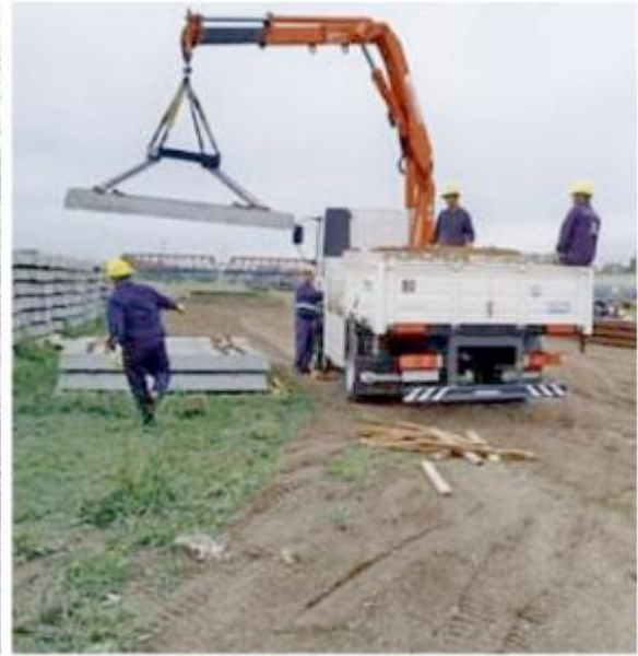
Movimiento durmiente de hormigón
