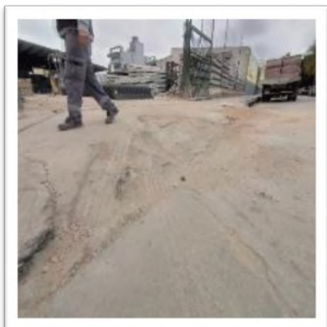
ESTADO DEL PISO ENTRE VEREDA Y CALLE PUBLICA
