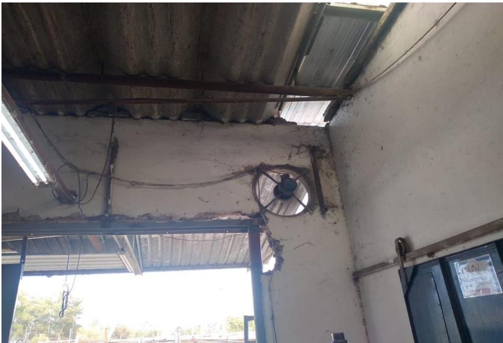
SALA DE EQUIPOS
