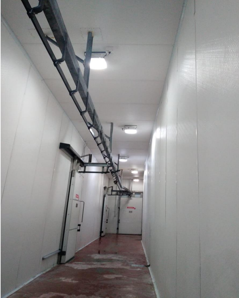
Luminaria en pasillo de cámaras
