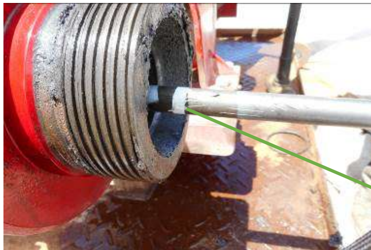
Llave de choke con marca de indicación de final de recorrido
