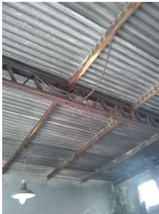
Ilustración 6 Conductores Eléctricos Sobre cabreadas
