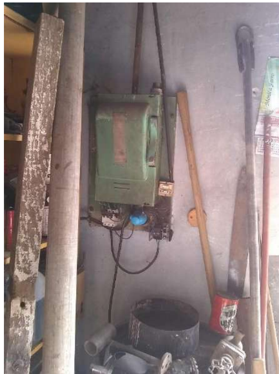
Ilustración 3 Tablero General Fuera de Norma
