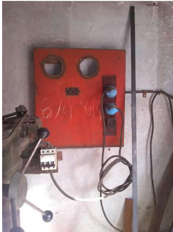
Ilustración 4 TomaCorriente Fuera de norma
