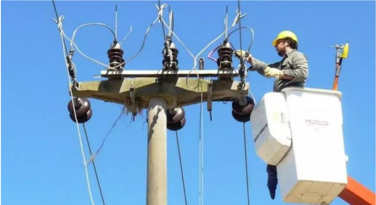
Trabajo sin tensión
