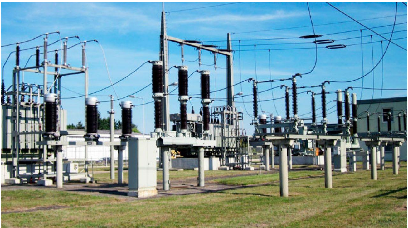
Sub Estación de Colón – Buenos Aires
