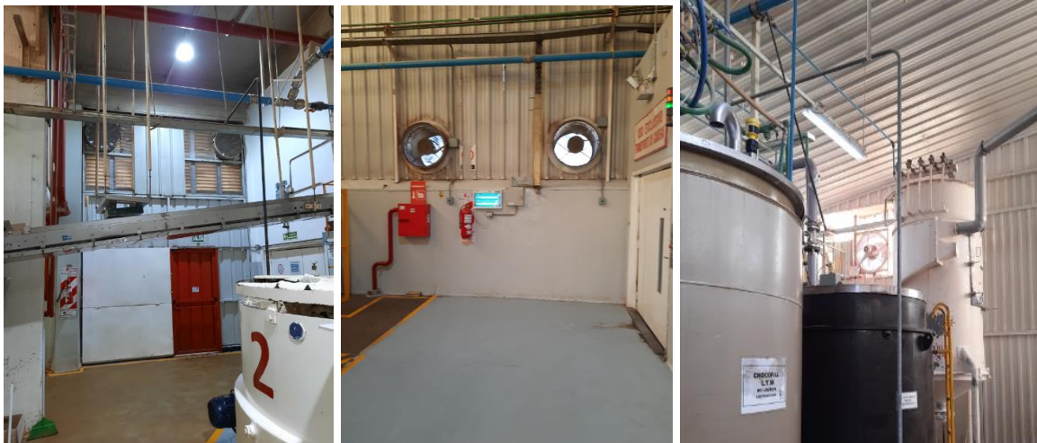
FIGURA 31 – Foto Planta de Pastas. Ventiladores y extractores existentes.
