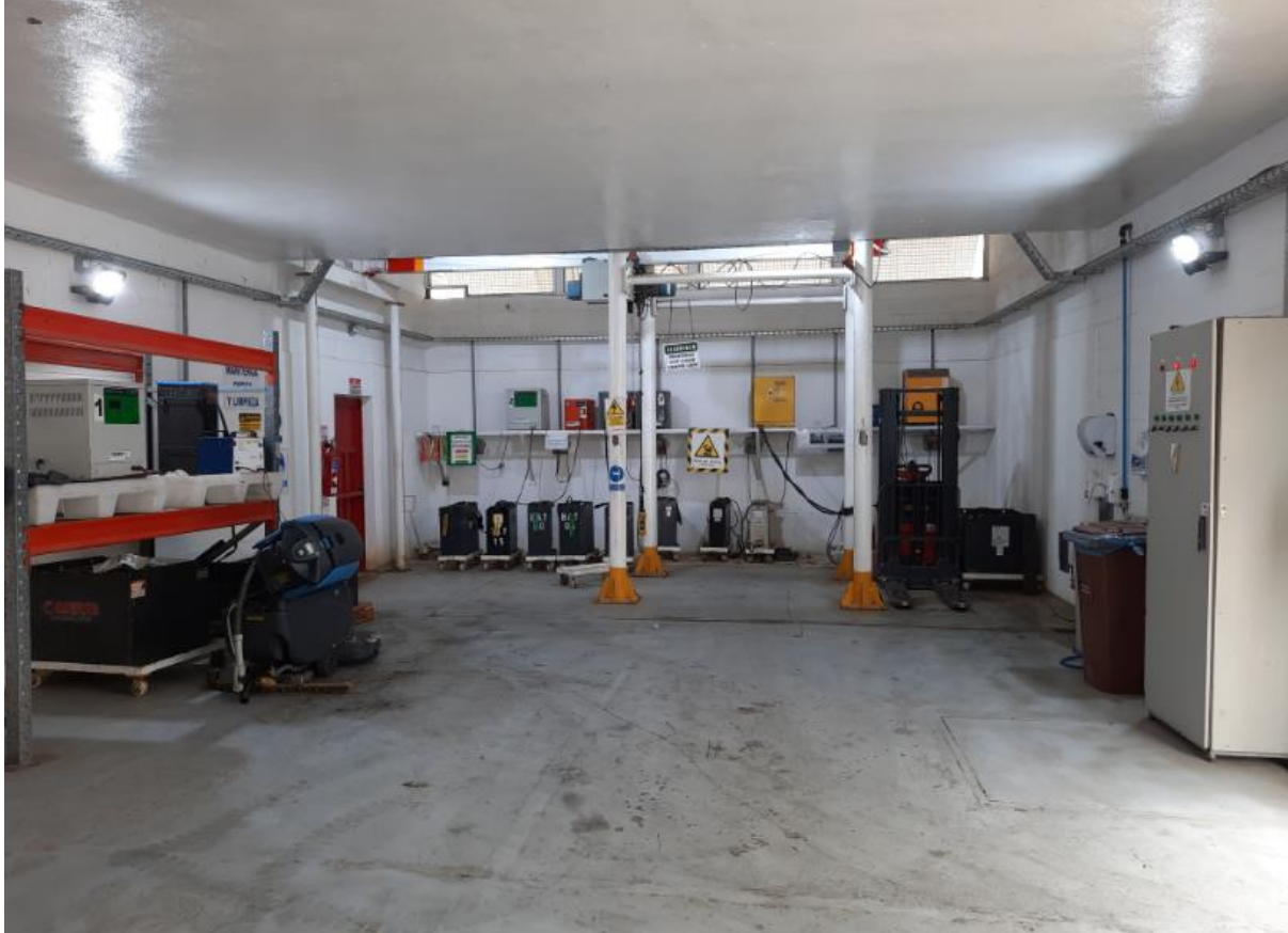
FIGURA 47 – Sala de carga de baterías actual.
