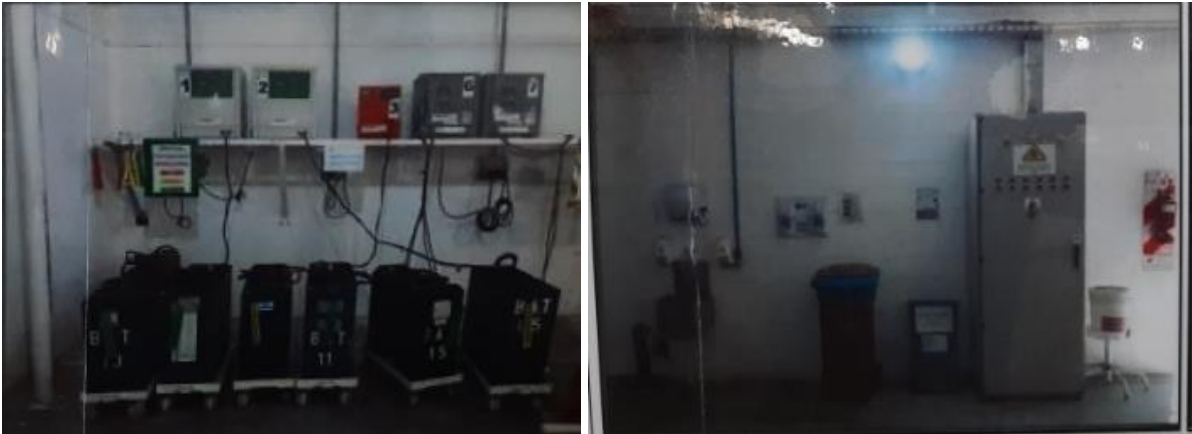
FIGURA 41 – Foto sala de carga de baterías antigua.
