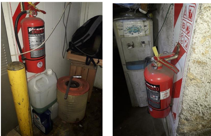
Figura 39 Extintores en cámaras de frío.
