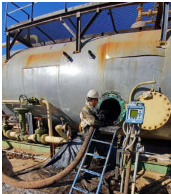
Boca de ingreso a diferente nivel del suelo con operador sosteniendo manguera de Vector
