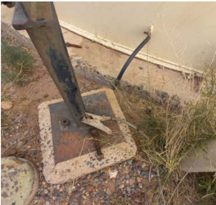
PAT RECINTO (SIRVE EMÁS PARA LA PAT DE EQUIPOS)
