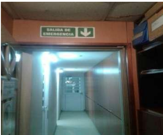
Iluminación de emergencia
