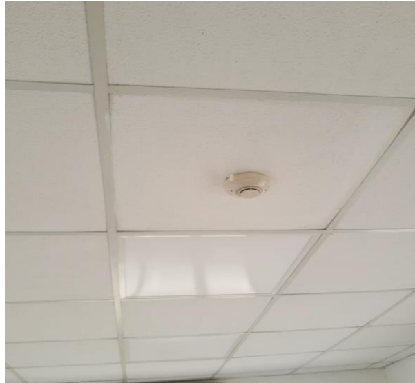
Detectores de humo en oficinas
