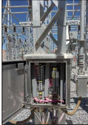
Imagen 5: Vista general de un seccionador de PAT.
