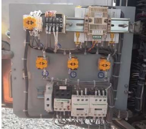
Imagen 15: Parte trasera de compuerta interna del tablero.
