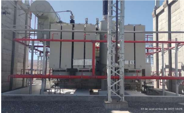
Transformador monofásico de potencia 345 kV
