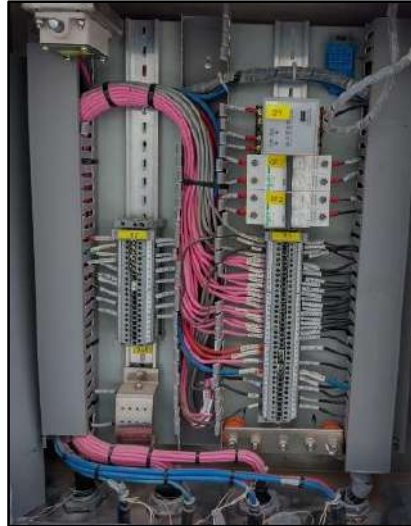
Imagen 3: Vista conexiones de tablero de Seccionador de Línea.
