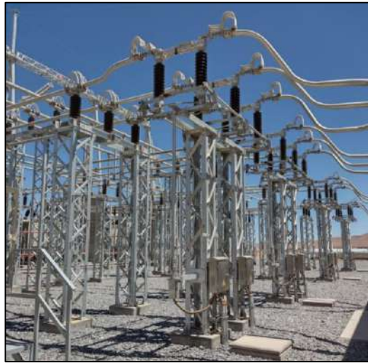
Imagen 1: Vista general de los seccionadores de 33KV
