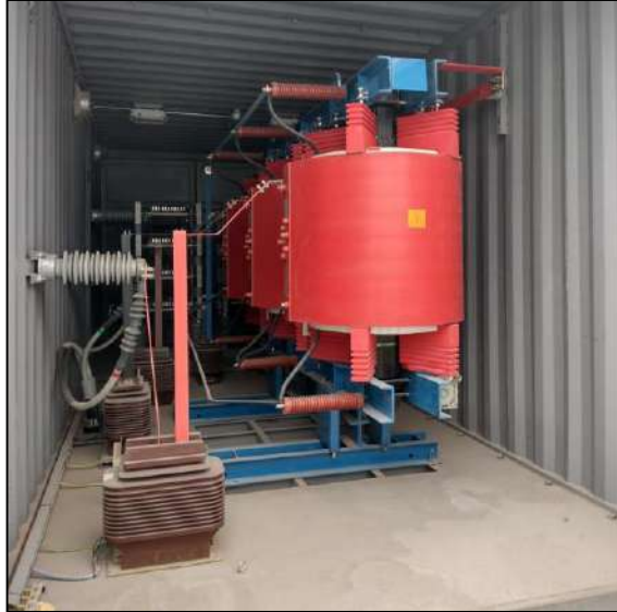
Imagen 1: Vista general de Transformador SSAA
