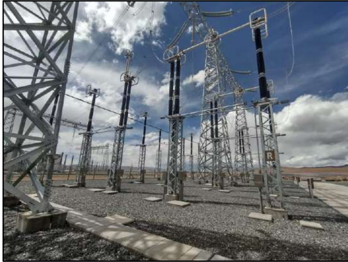
Imagen 7: Vista general de los seccionadores de 345KV.
