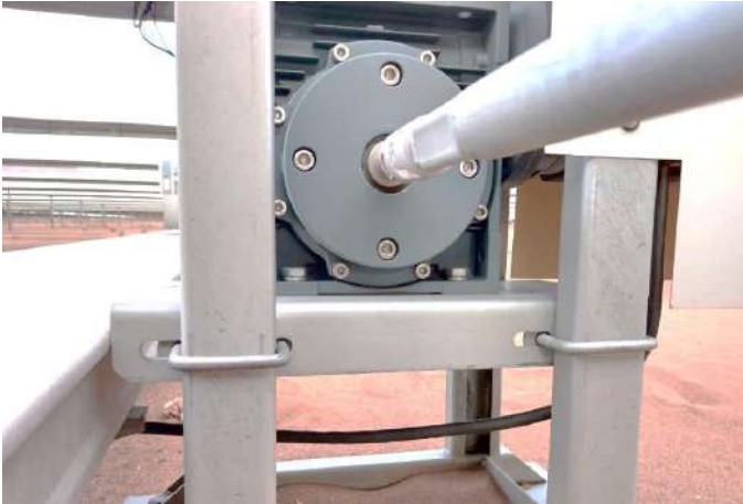
Imagen 17: Cable del motor
