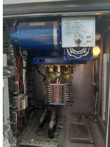
Imagen 16: Conexión al fondo del tablero.
