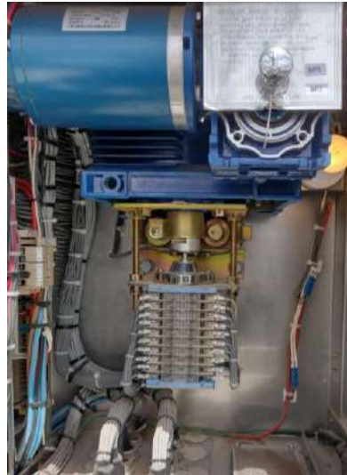
Imagen 11: Conexión al fondo del tablero.
