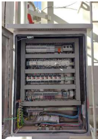
“Tablero de Control de Ventiladores”
