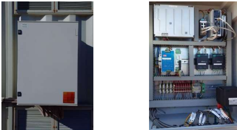
Imagen 1: Gabinete principal WS y cableado interno
