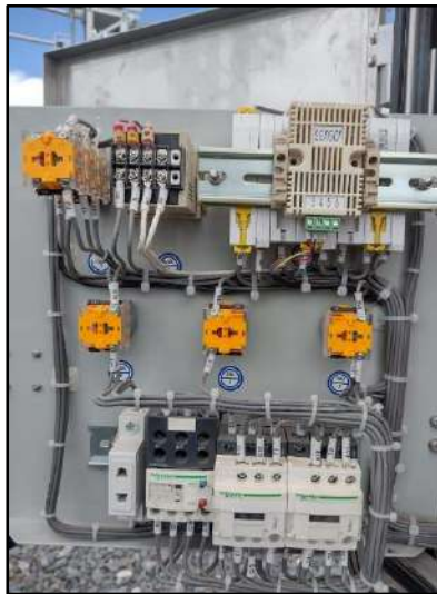
Imagen 10: Parte trasera de la compuerta interna del tablero.
