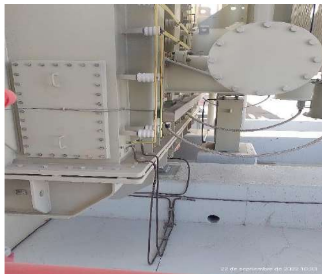
Imagen de conductor de puesta a tierra.
