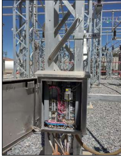
Imagen 2: Vista general de tablero de Seccionador de Línea.
