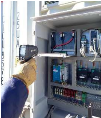
Imagen 2: Verificación de temperaturas anormales
