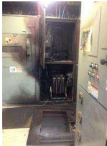
Figura 1: Registro fotográfico de la celda después del arco eléctrico.
