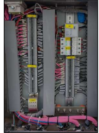
Imagen 6: Vista conexiones de tablero de seccionador de PAT.
