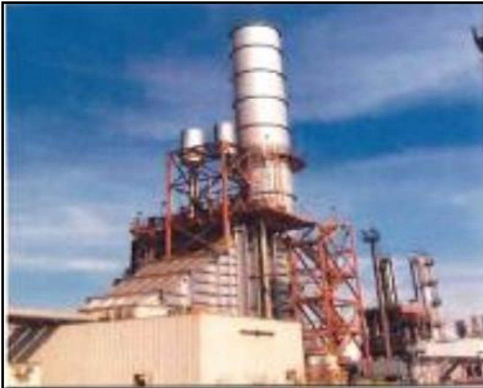
Figura N°2 – Turbina y chimenea de caldera
