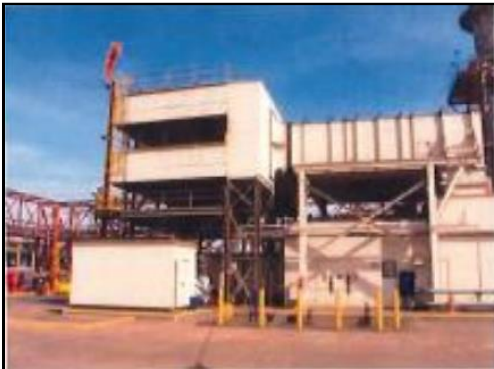
Figura N°3 – Casa de Filtros y admision de aire
