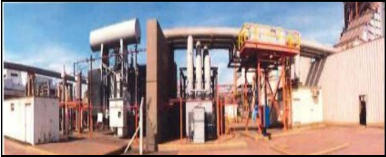
Figura N°4 – Generador y Transformadores de electricidad
