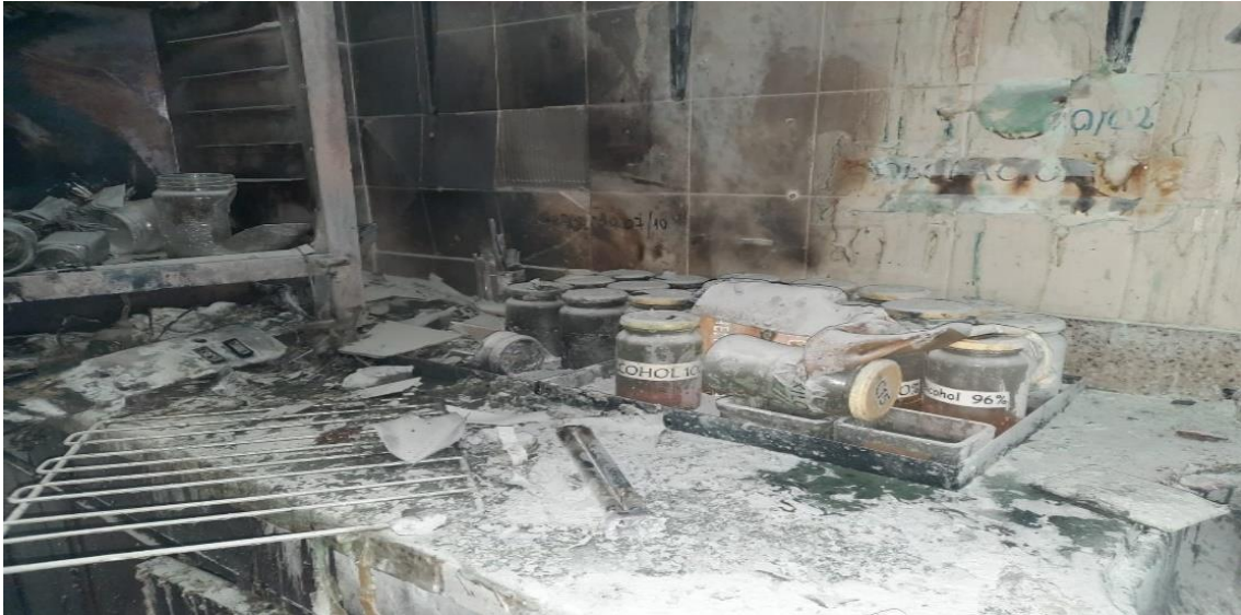
Foto 6. Incendio (fuente: foto propia)
