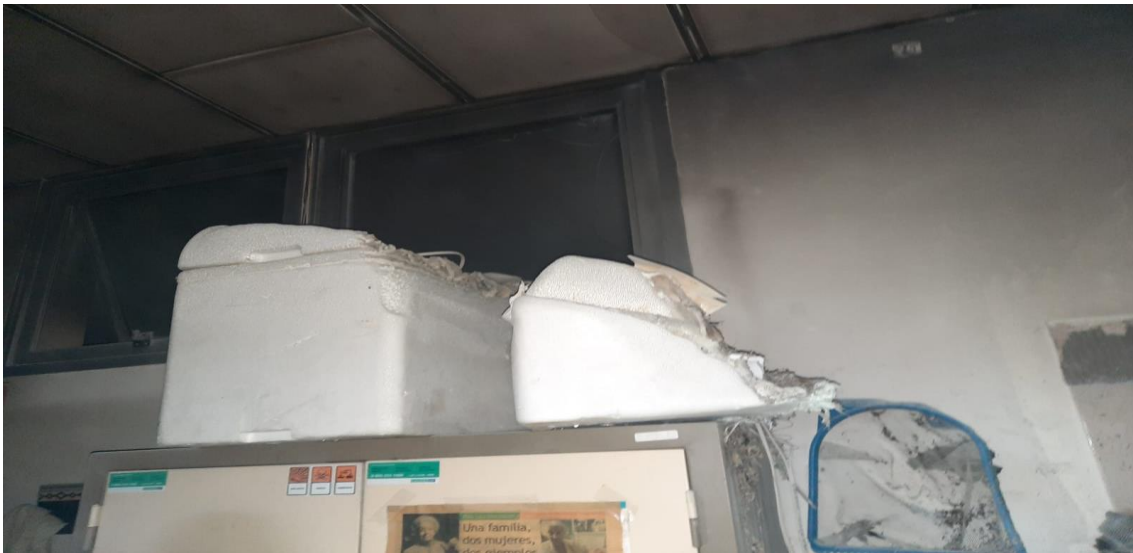
Foto 7. Incendio (fuente: foto propia)
