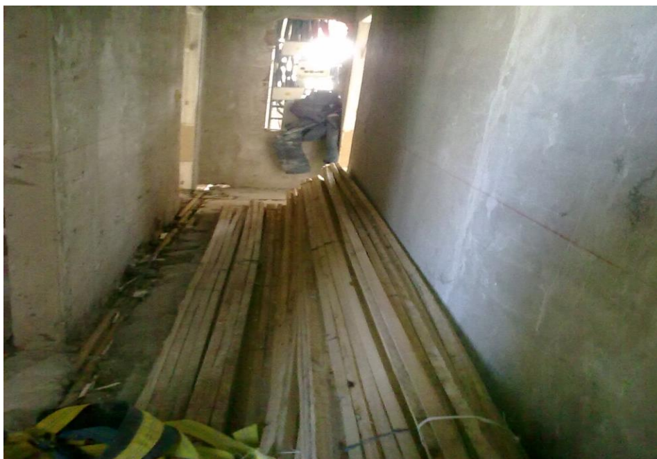
Imagen 50. Material obstruyendo Vías de Circulación.
