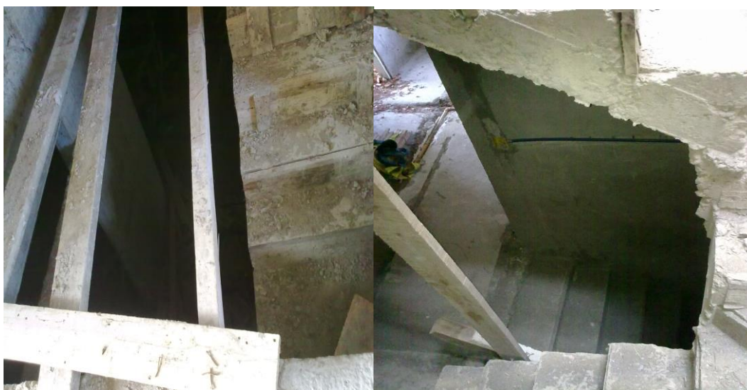
Imagen 10. Falta de Protección Colectiva en Escaleras.
