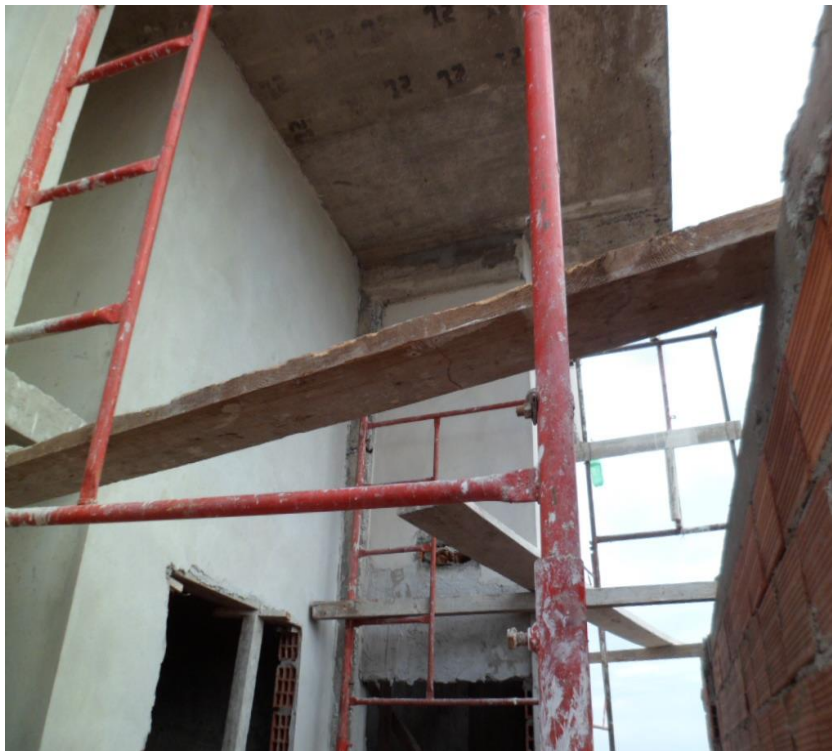
Imagen 12. Andamio armado en forma insegura.
