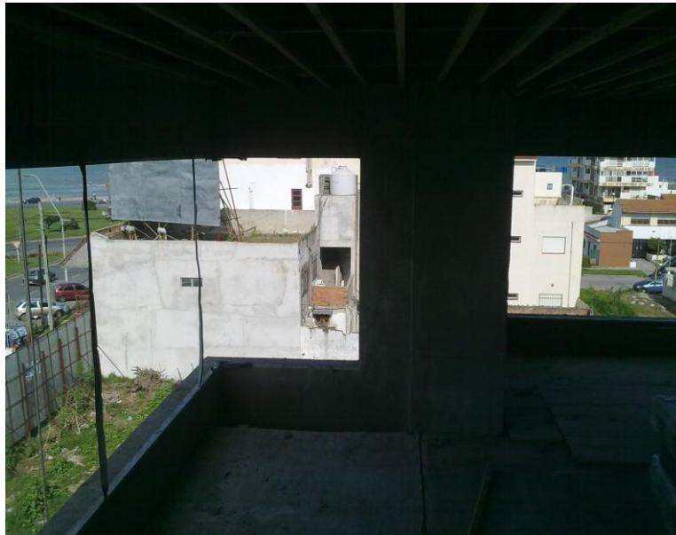
Imagen 7. Aberturas sin Protección Colectiva.
