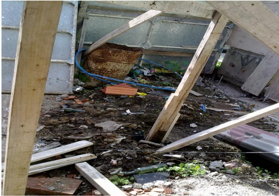
Imagen 49. Falta de Orden y Limpieza.
