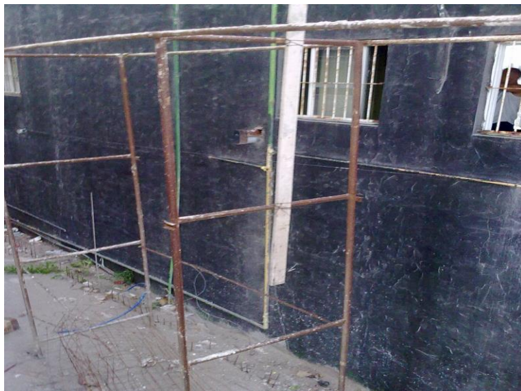
Imagen 11. Andamio con faltante de piezas.
