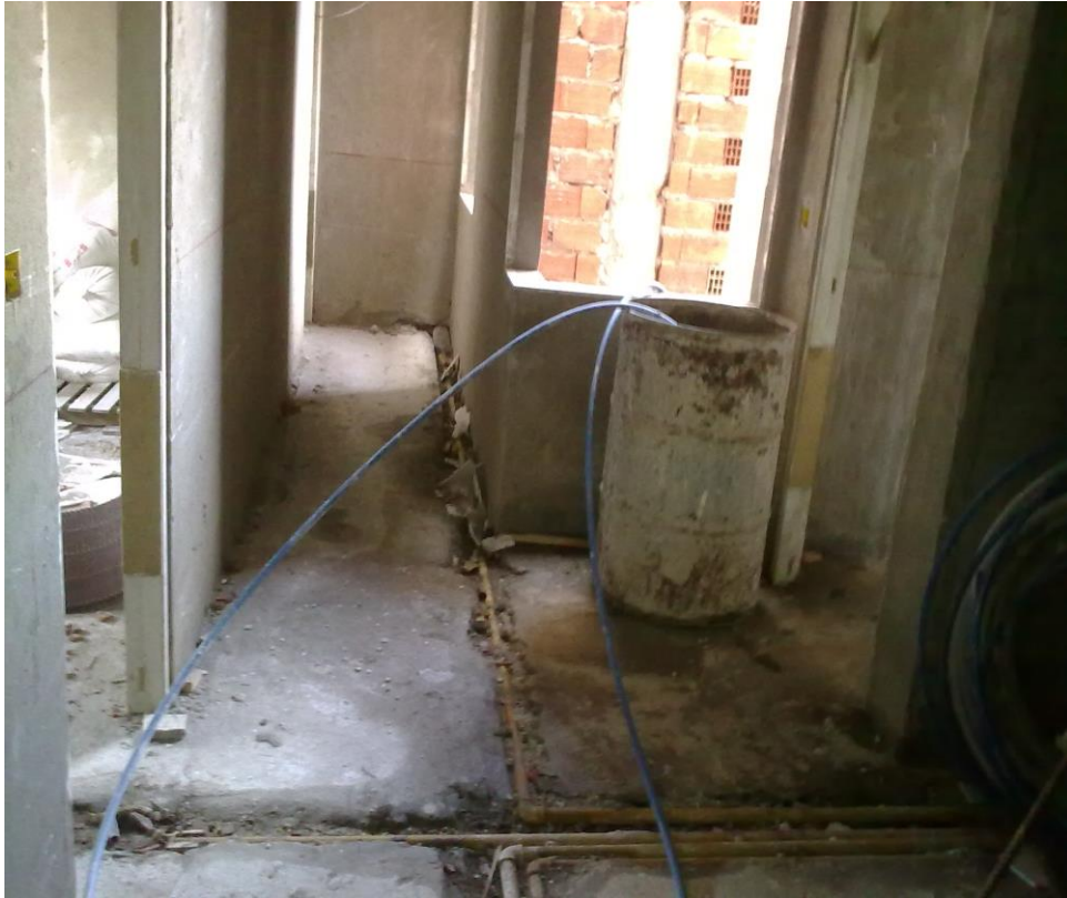
Imagen 47. Mangueras que obstruyen las Vías de Circulación.
