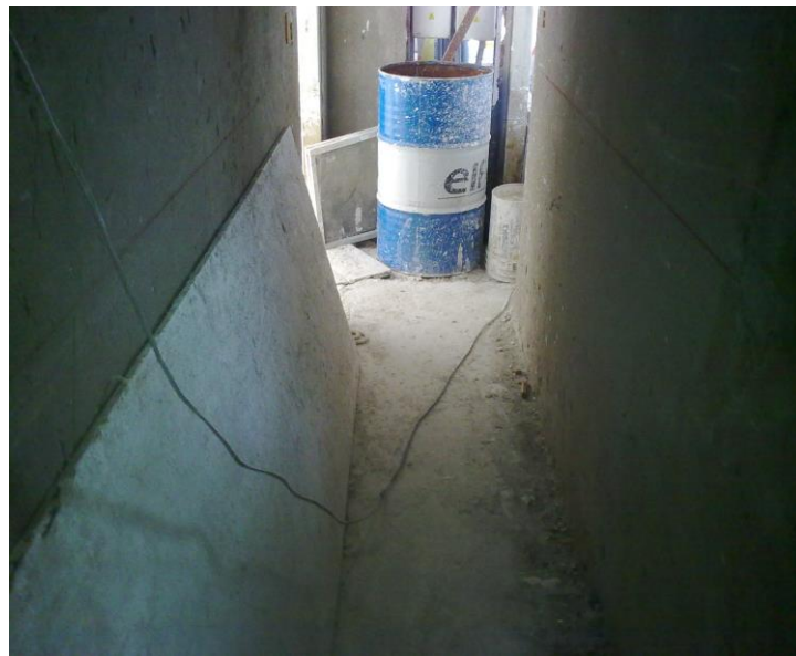
Imagen 29. Instalación Eléctrica obstruyendo la vía de circulación.
