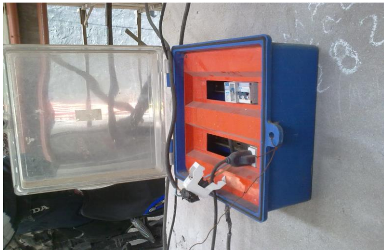
Imagen 30. Tablero Eléctrico de Obra.
