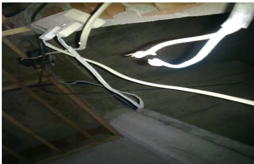
Imagen 44. Cableado Obstruyendo Vías de Circulación.
