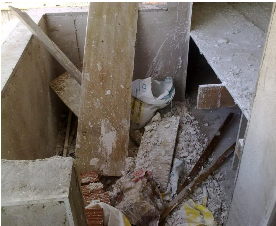
Imagen 48. Falta de Orden y Limpieza.
