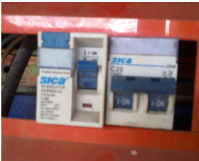
Imagen 27. Tablero Eléctrico de Obra.
