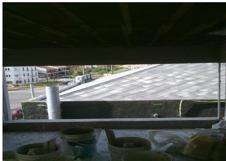
Imagen 8. Aberturas sin Protección Colectiva.
