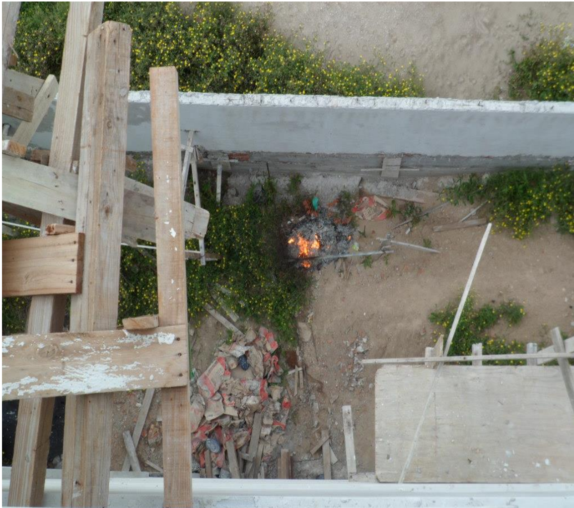
Imagen 54. Riesgo de Incendio.
