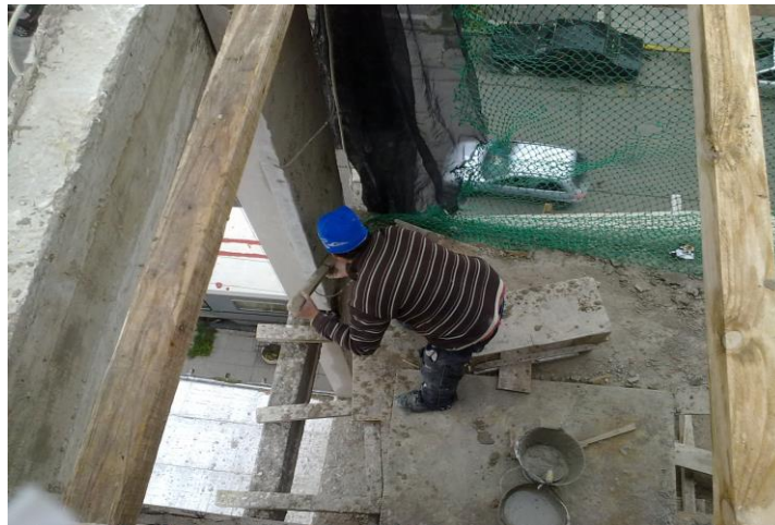
Imagen 6. Trabajador bajo riesgo de caída a distinto nivel.
