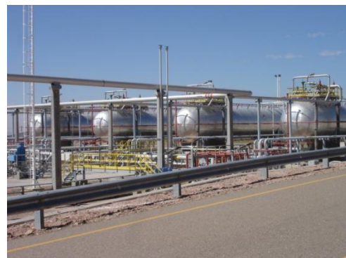
Foto 2.58: Válvulas de alivio de presión sobre los recipientes.
