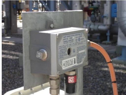
Foto 2.59: Detectores de gases
