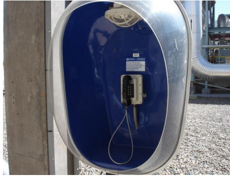
Foto 3.6 – Equipos de Comunicación Internos
