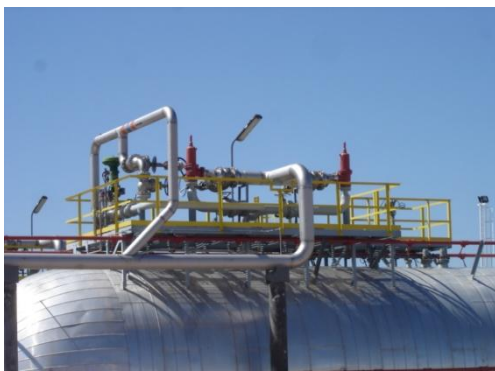
Foto 2.57: Válvulas de alivio de presión.
