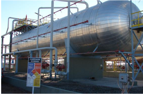
Foto 2.55: Sistema de rocío de agua de color rojo, ubicadas sobre el recipiente.
