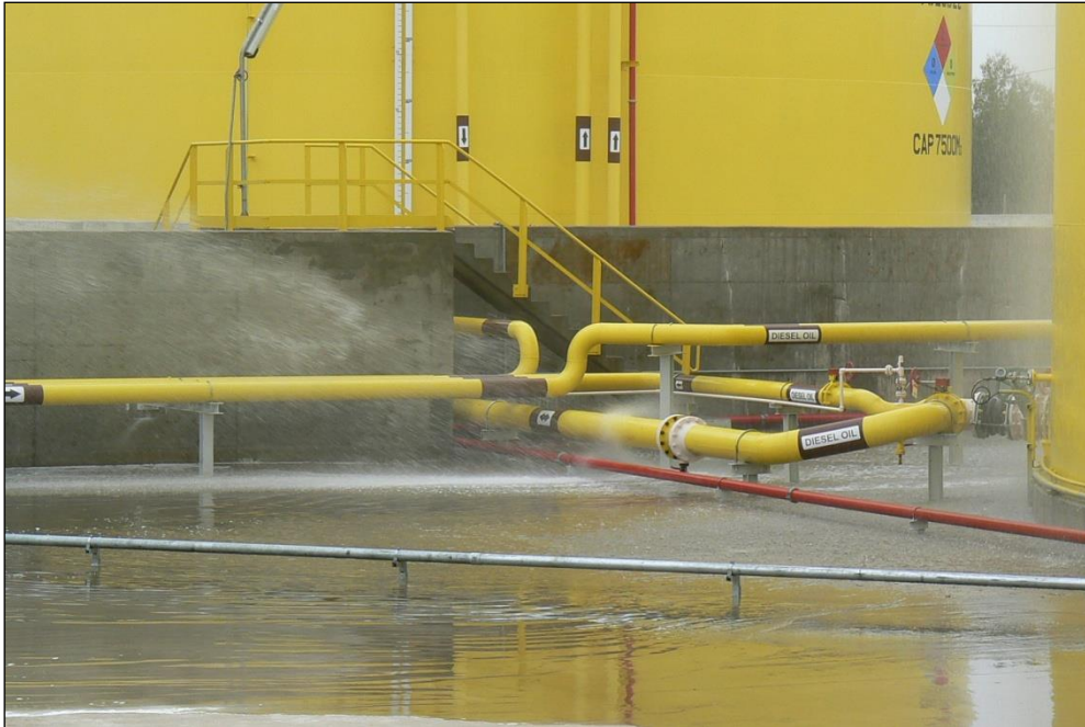
Sector del supuesto incendio con espuma ignifuga desde hidrante y refrigeración con agua del tanque.
