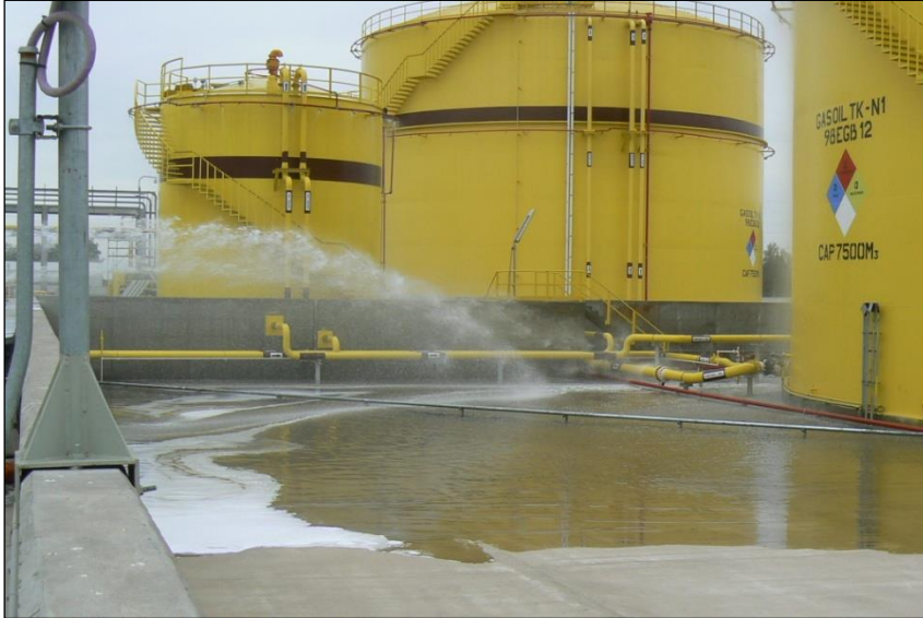
Vista de inyección de espuma desde un hidrante sobre el supuesto foco de incendio.
