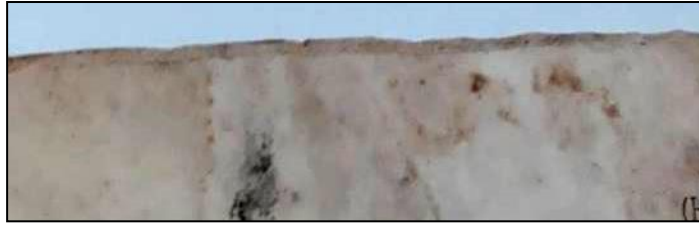
Figura 9: Manchas por moho. Fuente: Elaboración propia
