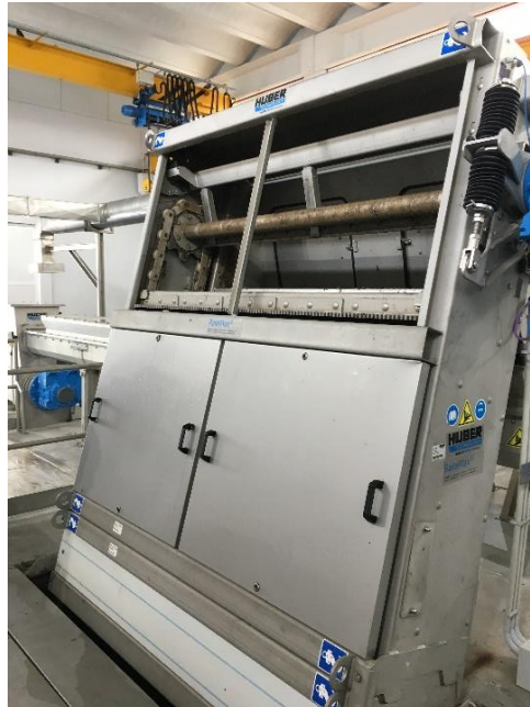
Imagen 5: Sistema de rejas finas, EDAR.
