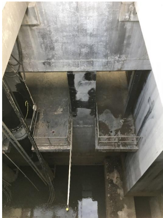
Imagen 3: Estación Elevadora, EDAR.
