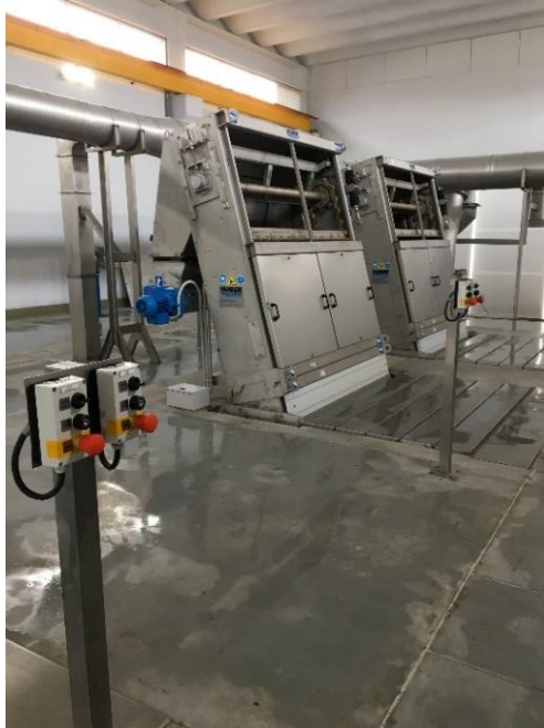
Imagen 4: Sistema de rejas finas, EDAR.
