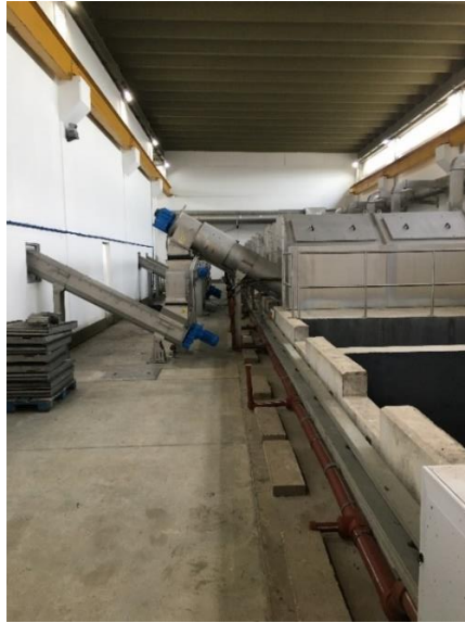
Imagen 8: Sala de cribas, EDAR.
