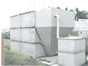
Reactor de Lodos Activados
