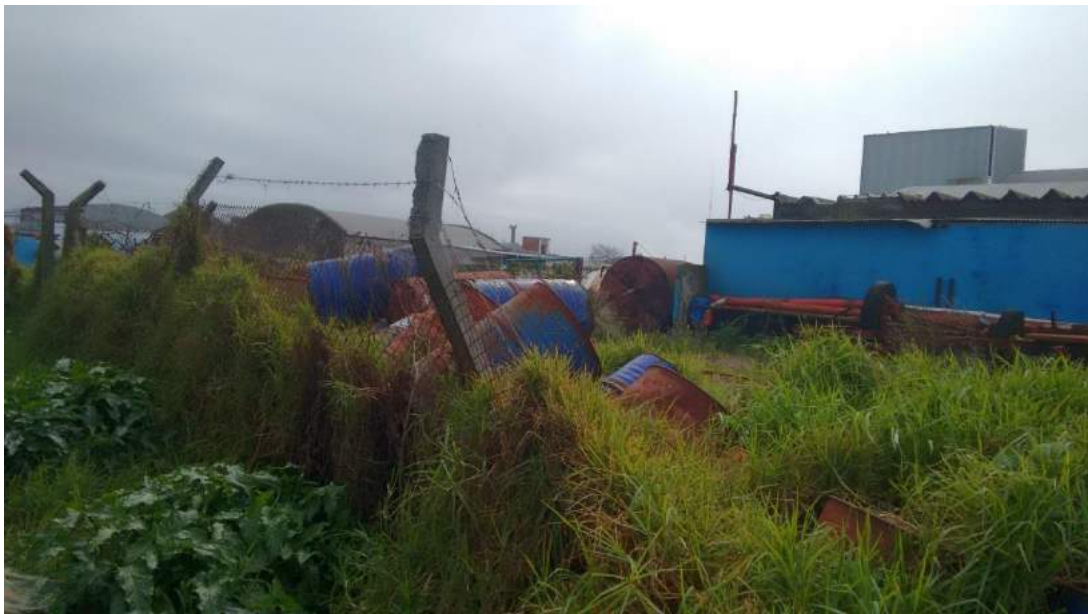
Figura 26 – Alambrado en malas condiciones al N de la RNPMdP.
